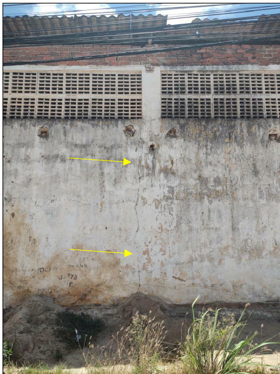
Foto 10: Trinca transpassante (setas amarelas) e vertical no muro norte do imóvel, visto da rua. Direção inferida 350° Az em relação ao dano da Foto 11 .
