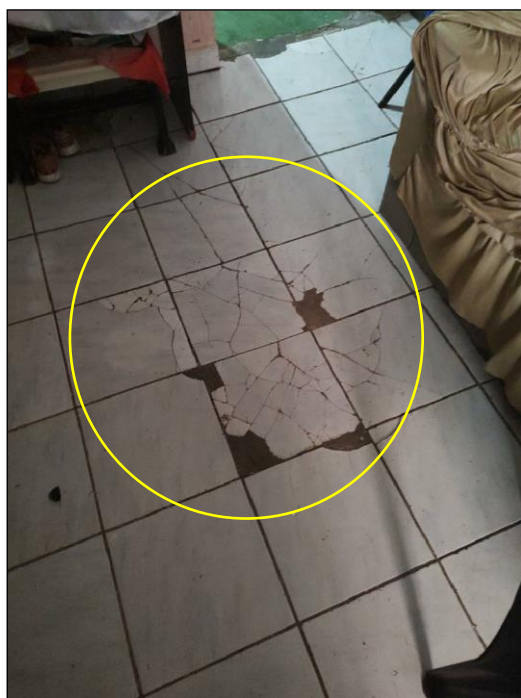
Foto 79: Afundamento de piso (elipse amarela) em casa localizada no fundo do vale. Moradora relatou danos na caixa de passagem e no esgoto abaixo da residência.
