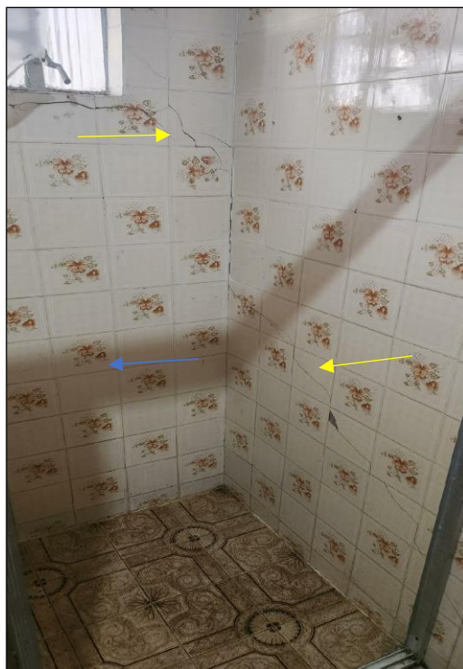
Foto 26: Trinca (indicada pela seta amarela) diagonal escalonada em paredes do banheiro, com direção 60° Az e indicando recalque diferencial para o sentido da bacia endorreica (indicado pela seta azul).
