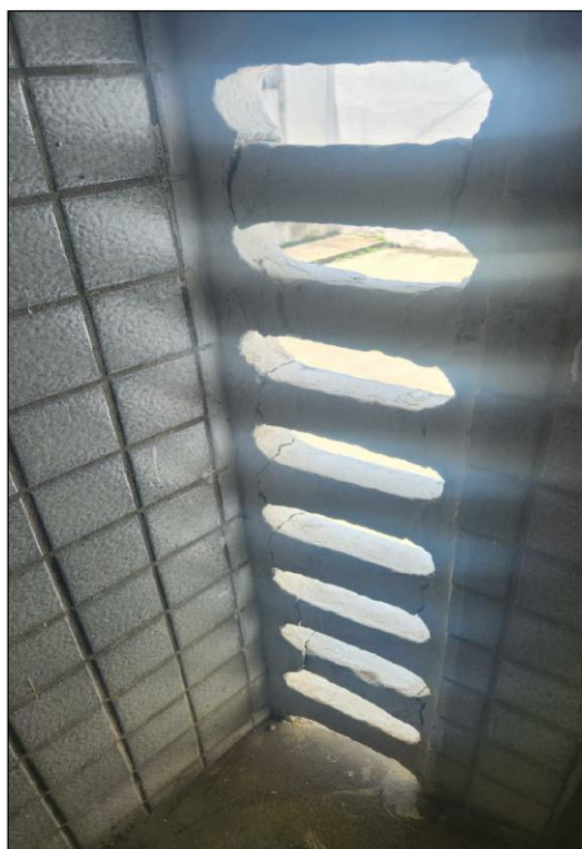
Foto 45: Cobogó danificado com trincas aparentes. Possível problema com a distribuição de tensões devido a estrutura vazada.
