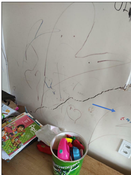
Foto 19: Rachadura diagonal na parede oposta do dano da Foto 18 . Direção inferida 20° Az em relação à rachadura da Foto 18 . Indicando recalque para noroeste (seta azul).
