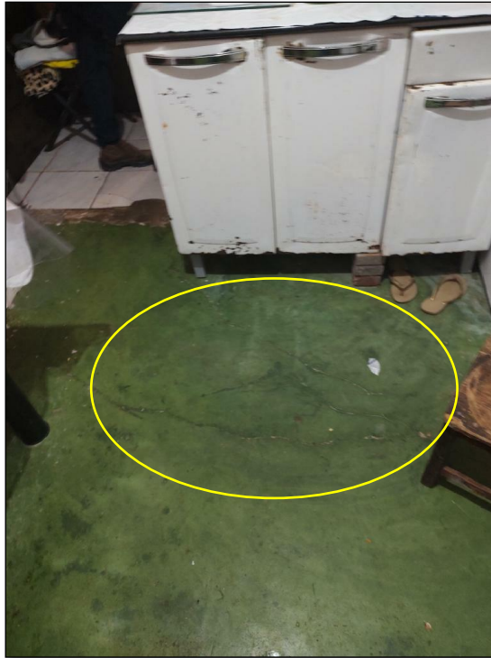
Foto 80: Danos (elipse amarela) e leve afundamento no pavimento da cozinha do mesmo imóvel da Foto 79 .
