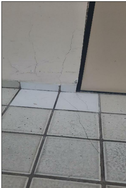
Foto 62: Trincas se propagando do piso da sala 01 para a parede. Direção 65° Az. O fato de a trinca apresentar abertura maior na parte de cima, em relação a sua base, indica tombamento para o sentido do lado direito da foto.
