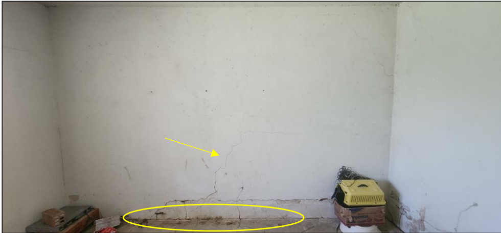
Foto 28: Fissuras e trincas (seta amarela) na parede e leve afundamento (elipse amarela) do pavimento.
