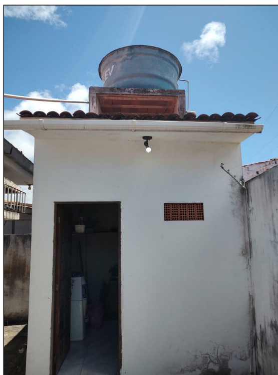
Foto 22: Anexo construído em alvenaria autoportante com caixa d'água posicionada em local que está gerando sobrecarga nas paredes.
