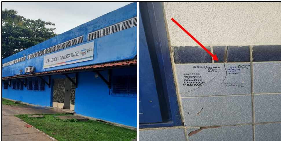
Figura 21 - AT05_3- Fissuras na cerâmica na área interna da edificação.
