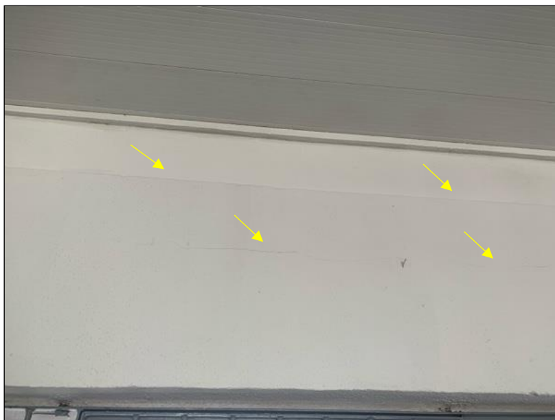
Foto 42: Fissuras horizontais incipientes (setas amarelas) se propagando pelo topo da parede de uma sala de aula.
