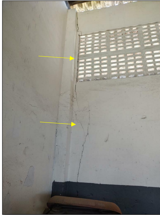
Foto 12: Trinca (setas amarelas) se propagando do topo até base da parede, vista do pátio. Direção inferida 350^\circ Az em relação à trinca da Foto 13 . É possível observar ausência de elementos estruturais para carregamento e distribuição de tensões além de apoio indevido do telhado.
