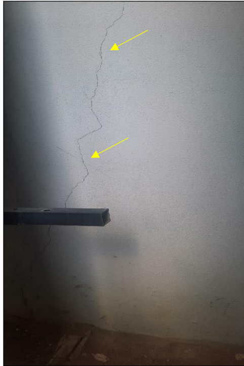
Foto 60: Fissura vertical transpassante (setas amarelas) da Foto 59 , na parte de trás da parede.
