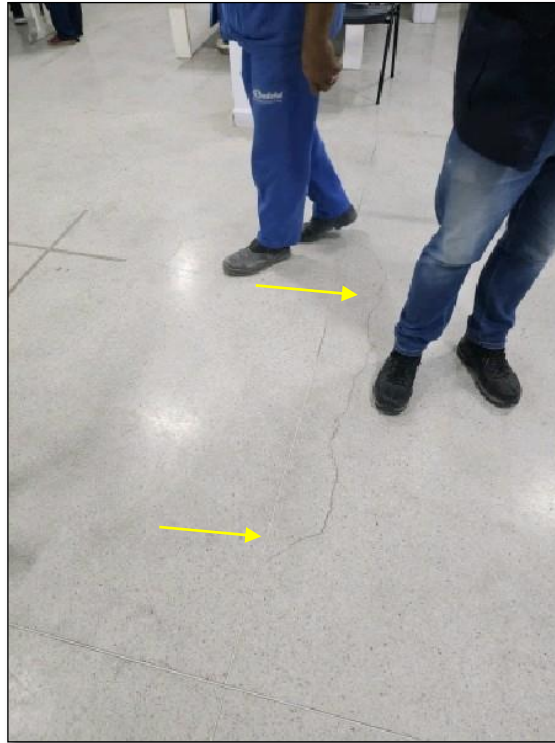
Foto 46: Fissura (indicada pelas setas amarelas) no piso de granilite com direção de propagação de aproximadamente 340° Az.
