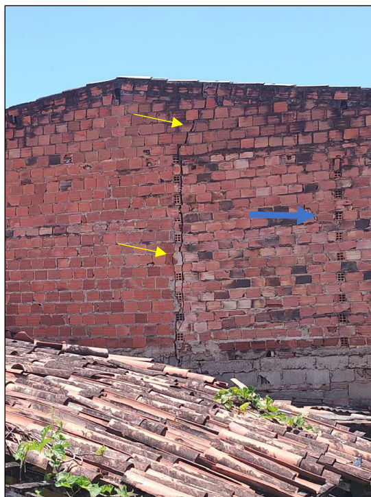
Foto 76: Fachada externa de um imóvel apresentando rachadura transpassante (indicado pelas setas amarelas) indicando recalque para o sentido do caimento da encosta (indicado pela seta azul).
