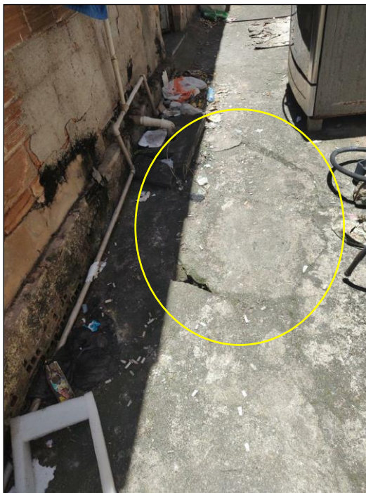
Foto 78: Pavimento danificado (elipse amarela) em área de percolação em alta velocidade de águas pluviais relacionado ao carreamento do leito do solo.
