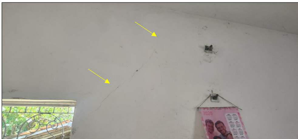
Foto 21: Fissura (seta amarela) se propagando da janela pela parede. É possível observar a ausência de vergas e contravergas para distribuição das tensões.
