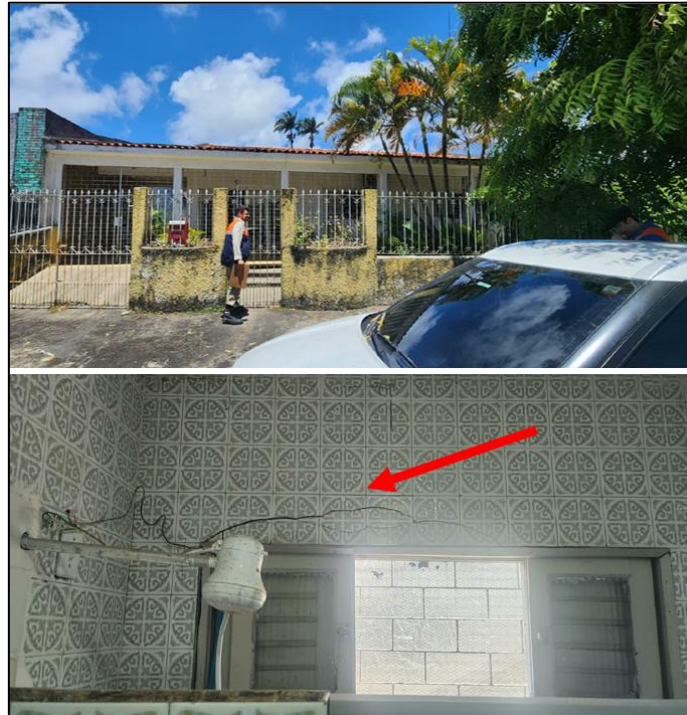
Figura 13 – AT-03_154 -Trinca na horizontal, situada na cerâmica do banheiro. Possível causa: vícios construtivos/ausência de manutenção.
