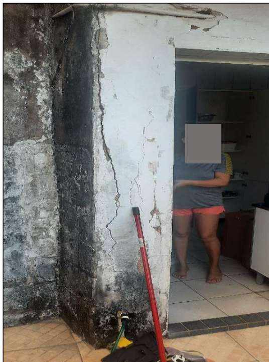
Foto 3: Paredes em estado avançado de deterioração com infiltrações e consequente oxidação da armadura gerando danos na estrutura.
