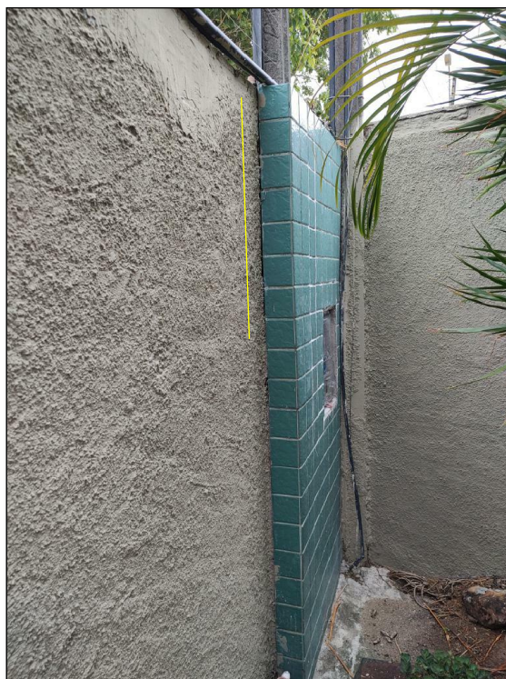
Foto 38: Fissura (indicada pela linha) vertical na junção de paredes sem a devida amarração.
