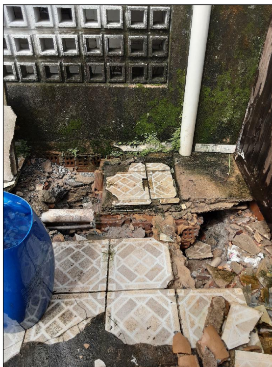
Foto 36: Degradação da parede relacionado a alagamentos periódicos. No local onde o pavimento está danificado, infiltram águas pluviais contribuindo para a erosão subsuperficial e acomodações por saturação de aterro não compactado.
