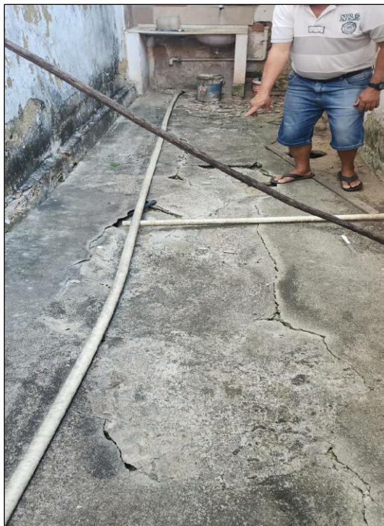
Foto 7: Afundamento de pavimento no quintal de um imóvel devido a problemas de erosão subsuperficial com carreamento dos sedimentos por passagem de águas. No local há caixa de gordura e caixas de passagem de água que aparentam estar danificadas.
