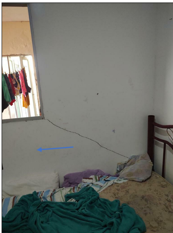
Foto 18: Rachadura diagonal na parede do quarto do primeiro andar se propagando da janela até a base da parede. Direção inferida 20º Az em relação à rachadura da Foto 19. Indicando recalque para noroeste (seta azul).
