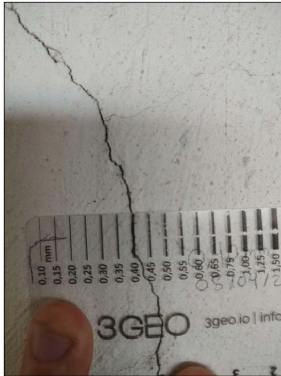
Foto 14: Fissura observada na parede norte, vista do pátio. Abertura máxima 0,4 mm. Na Foto 15 pode-se observar que o monitoramento mostra que não houve evolução desde abril de 2023.
