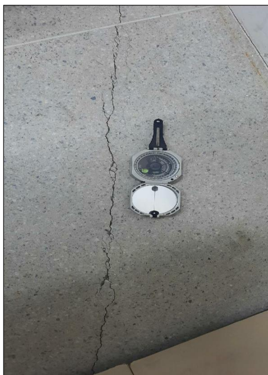
Foto 49: Fissura no piso de granilite com direção de propagação de aproximadamente 70° Az no detalhe.
