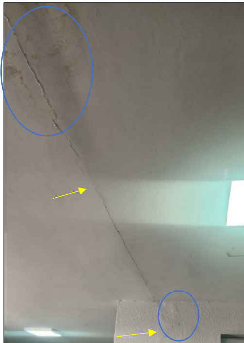
Foto 40: Fissuramento (setas amarelas) na laje, agravada por infiltrações (elipses azuis) se propagando pela parede como evidenciado na Foto 41 .
