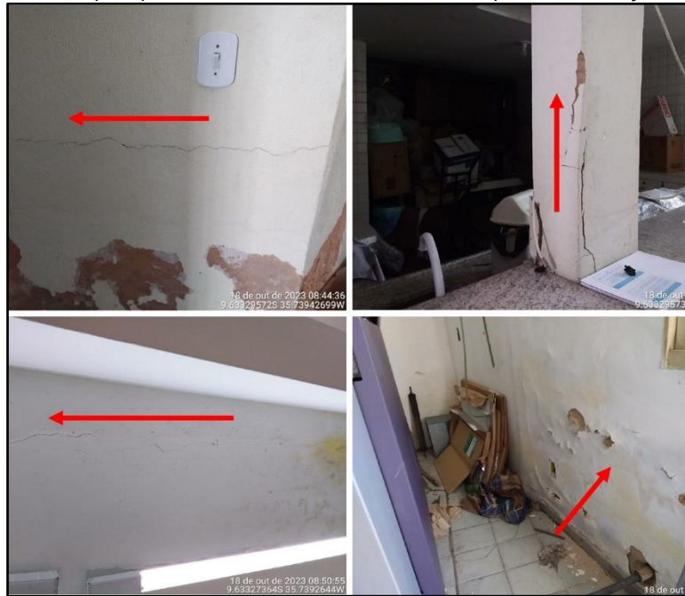
Figura 16 – AT04_5 – Fissura na horizontal na parede de alvenaria; Infiltrações causando deslocamento de reboco, Fissura no pilar podendo estar correlacionado a uma possível oxidação das armaduras.
