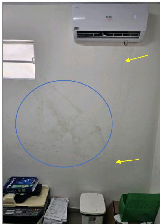
Foto 51: Fissura vertical incipiente (setas amarelas) se propagando partir do ar-condicionado em parede danificada por infiltração (elipse azul). Não há continuidade de propagação para o pavimento.
