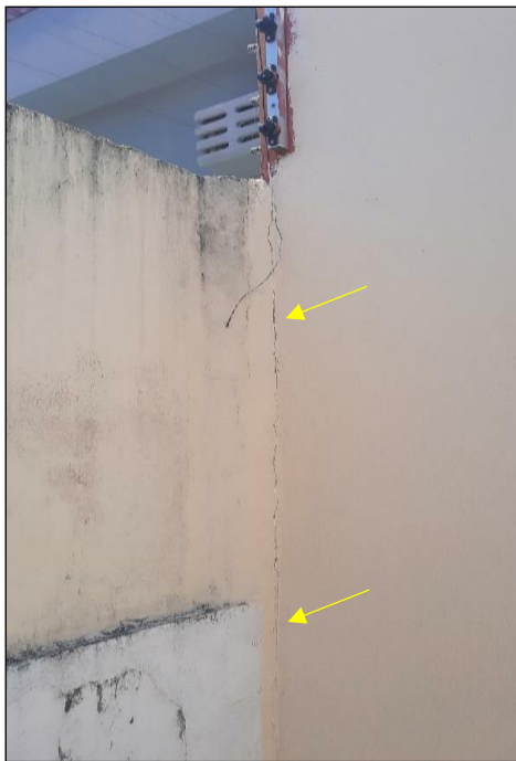
Foto 56: Fissura de descolamento entre muro e parede construídos sem a devida amarração.
