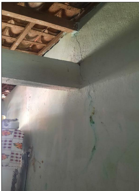
Foto 5: Dano na parede devido ao apoio direto do telhado sobre a alvenaria gerando sobrecarga pontual.
