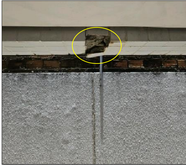
Foto 55: Pastilhas danificadas (elipse amarela) em viga que está sofrendo oxidação interna induzindo um estufamento na estrutura.
