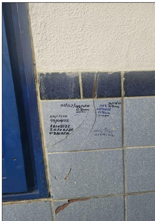
Foto 44: Danos da Foto 43 no detalhe.
