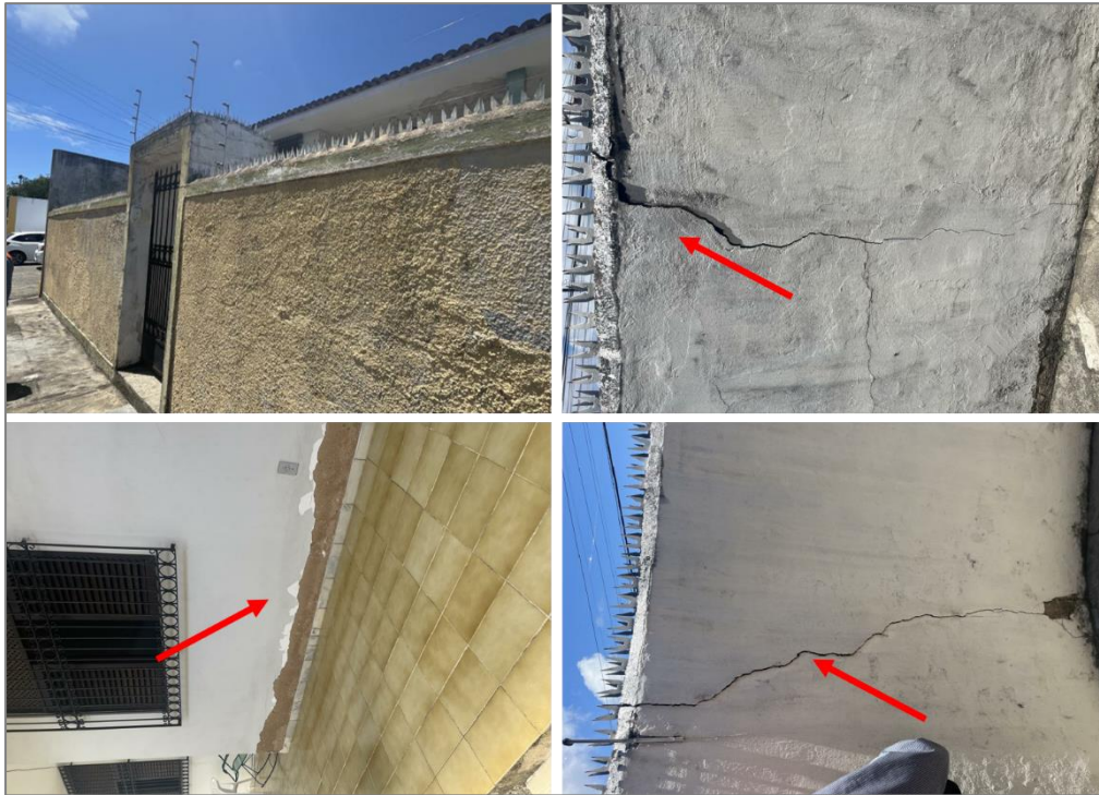
Figura 12 - AT- 03_79 - Rachadura na diagonal, situada no muro da parte externa da edificação, sem persistência para outros cômodos. Infiltração nas paredes
