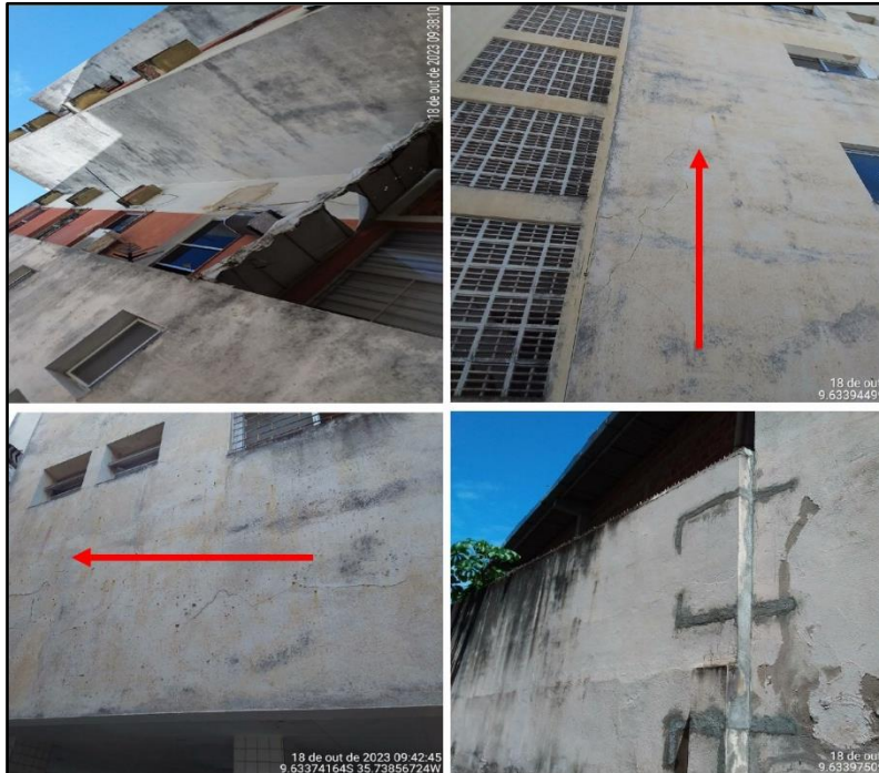
Figura 17 – AT04_21 – Fissuras na vertical e horizontal, situada na fachada do edifício; Manchas de infiltração no lado externo.
