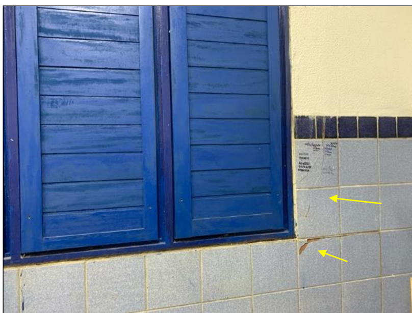
Foto 43: Fissura e deslocamento (setas amarelas) localizado em cerâmica relacionado à dilatação.
