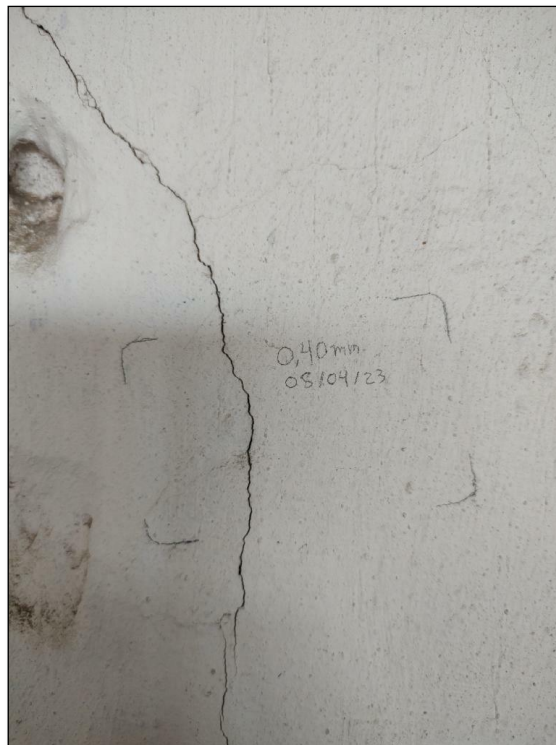
Foto 15: Trinca da Foto 14 no mesmo local em que foi medida. Observa-se que o monitoramento mostra que não houve evolução desde abril de 2023.
