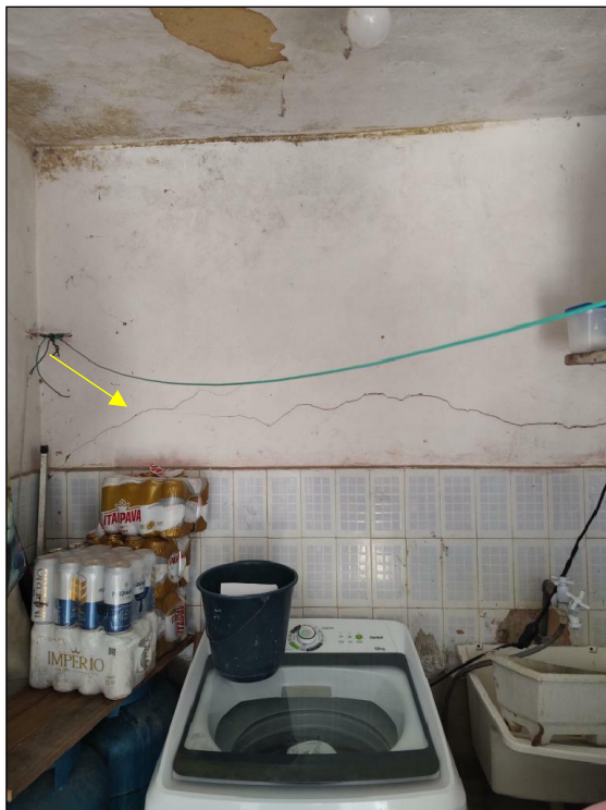
Foto 17: Trinca horizontal (seta amarela) em parede localizada ao lado da caixa de gordura da Foto 16.
