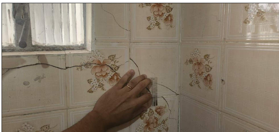
Foto 27: Trinca da Foto 26 no detalhe. Abertura de 1 mm.
