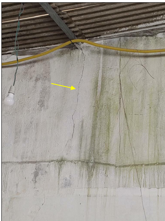
Foto 37: Fissura vertical (seta amarela) em parede relacionado à sobrecarga pontual do apoio do telhado.
