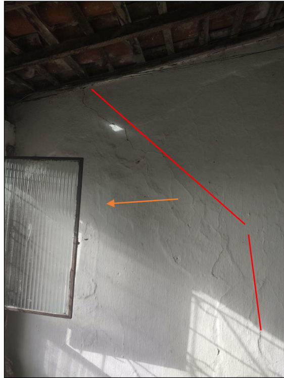
Foto 1: Construção localizada bem próxima da encosta. Trinca inclinada escalonada (indicada pela linha vermelha) se propagando do topo da parede até próximo à base. Patologia com indício de recalque na direção do declive da encosta (indicada pela seta laranja).
