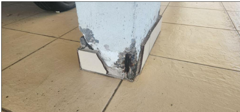
Foto 25: Pilar danificado devido a oxidação da armadura gerando estufamento.
