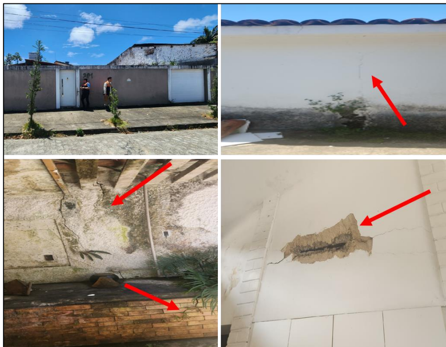
Figura 14 – AT-03_161 – Fissura na vertical, situada na parede do lado externo da edificação; Oxidação da armadura causando deslocamento de reboco; Infiltrações.
