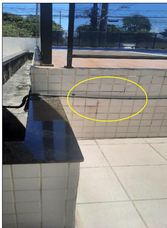
Foto 54: Descolamento (elipse amarela) nas pastilhas em exposição contínua ao sol que possivelmente agravou a dilatação do material.
