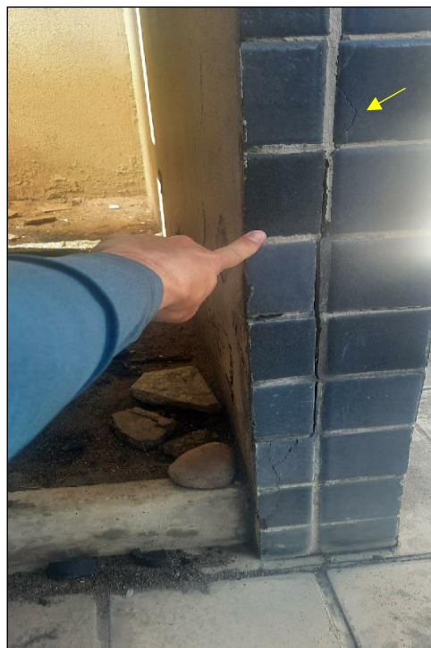
Foto 61: Fissura vertical se propagando pelo rejunte e pela pastilha em si (indicada pela seta amarela), mas de forma incipiente.
