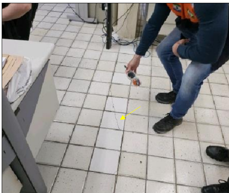
Foto 63: Trincas (indicadas pelas setas amarelas) se propagando pelo piso da sala 02. Direção 65° Az.
