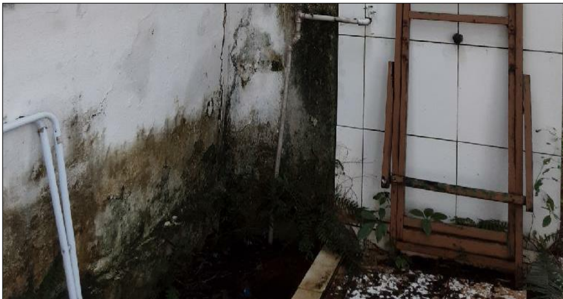
Foto 35: Parede danificada relacionada ao excesso de umidade. Além de ficar exposta à chuva, sofre também com a ascensão da umidade por capilaridade da água, a partir da zona de umidade do solo agravada por submersão parcial em períodos de alagamentos.
