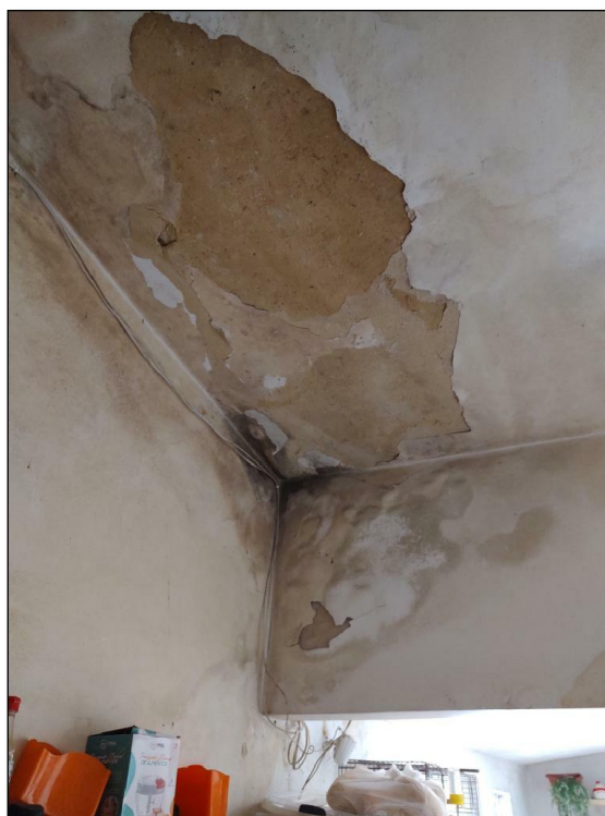
Foto 24: Teto e paredes danificadas devido às consequências de infiltração severa sem manutenção.
