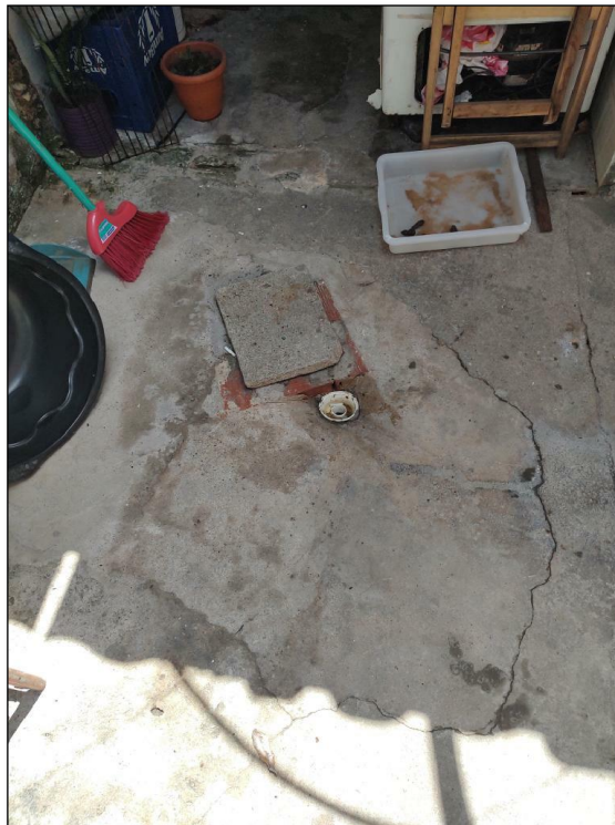
Foto 16: Danos em pavimento onde há uma caixa de gordura que está gerando recalque localizado e afetando parede ao lado como evidenciado na Foto 17 .
