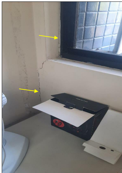
Foto 69: Fissura transpassante (indicada pelas setas amarelas) se propagando pela parede até a janela.
