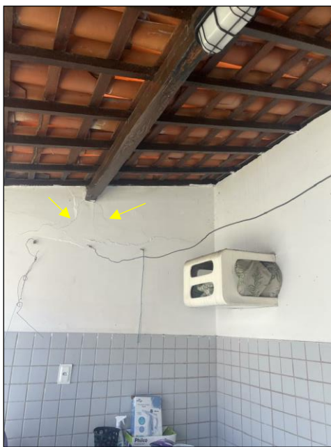
Foto 57: Apoio do telhado direto sobre a parede gerando fissuras (indicadas pelas setas amarelas) devido à sobrecarga pontual.
