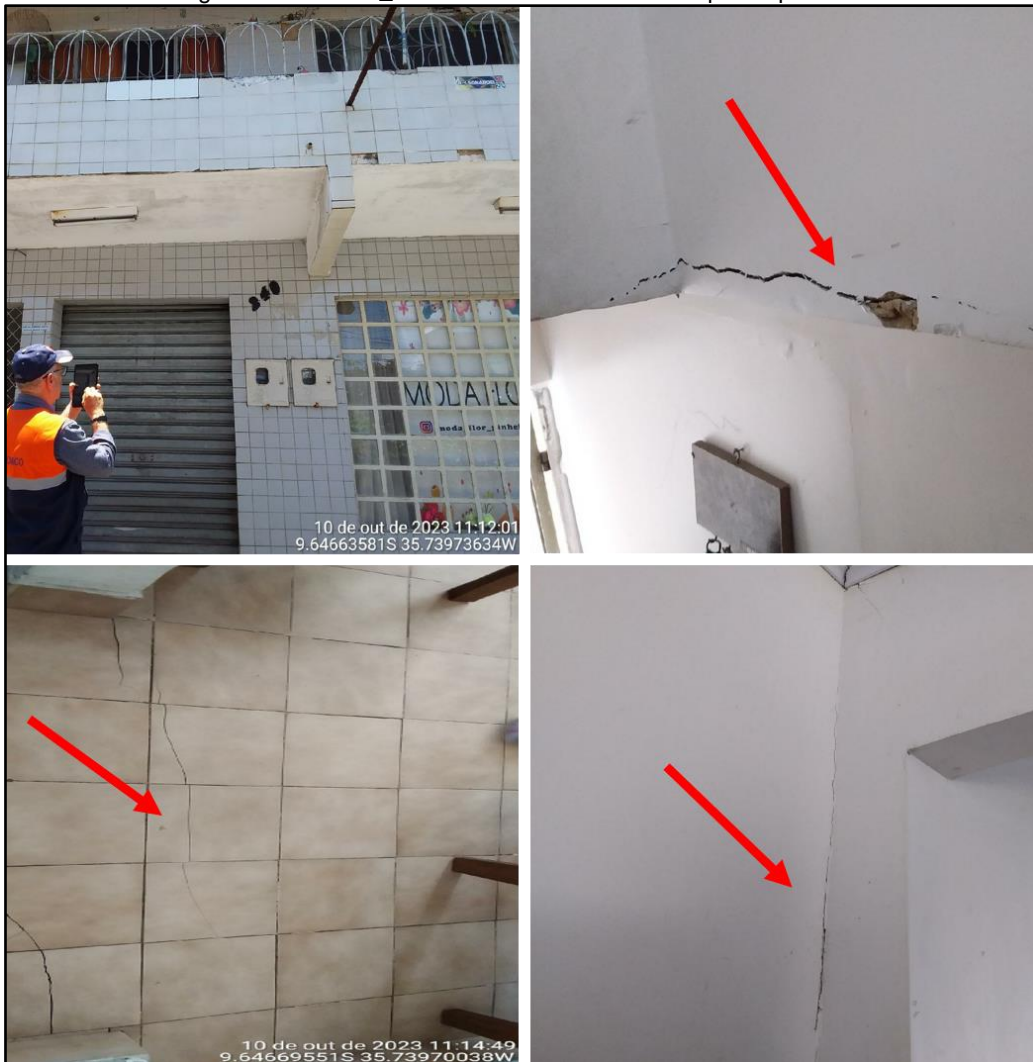
Figura 24 – AT06A_223 – Danos encontrados no piso e paredes.
