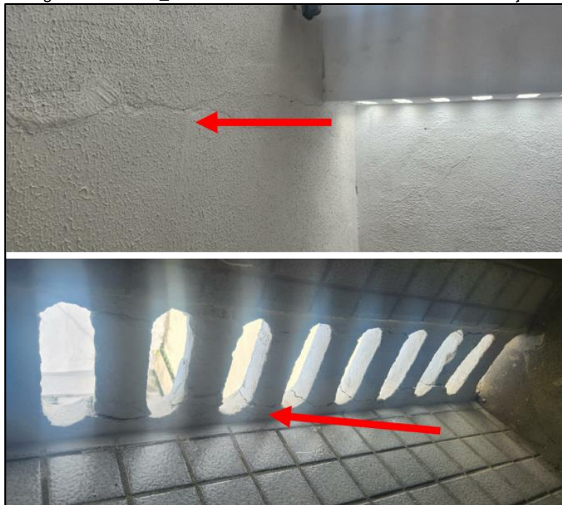
Figura 20 – AT05_4 - Danos identificados na estrutura da edificação.
