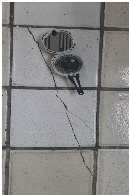
Foto 64: Trincas da Foto 63 no detalhe.
