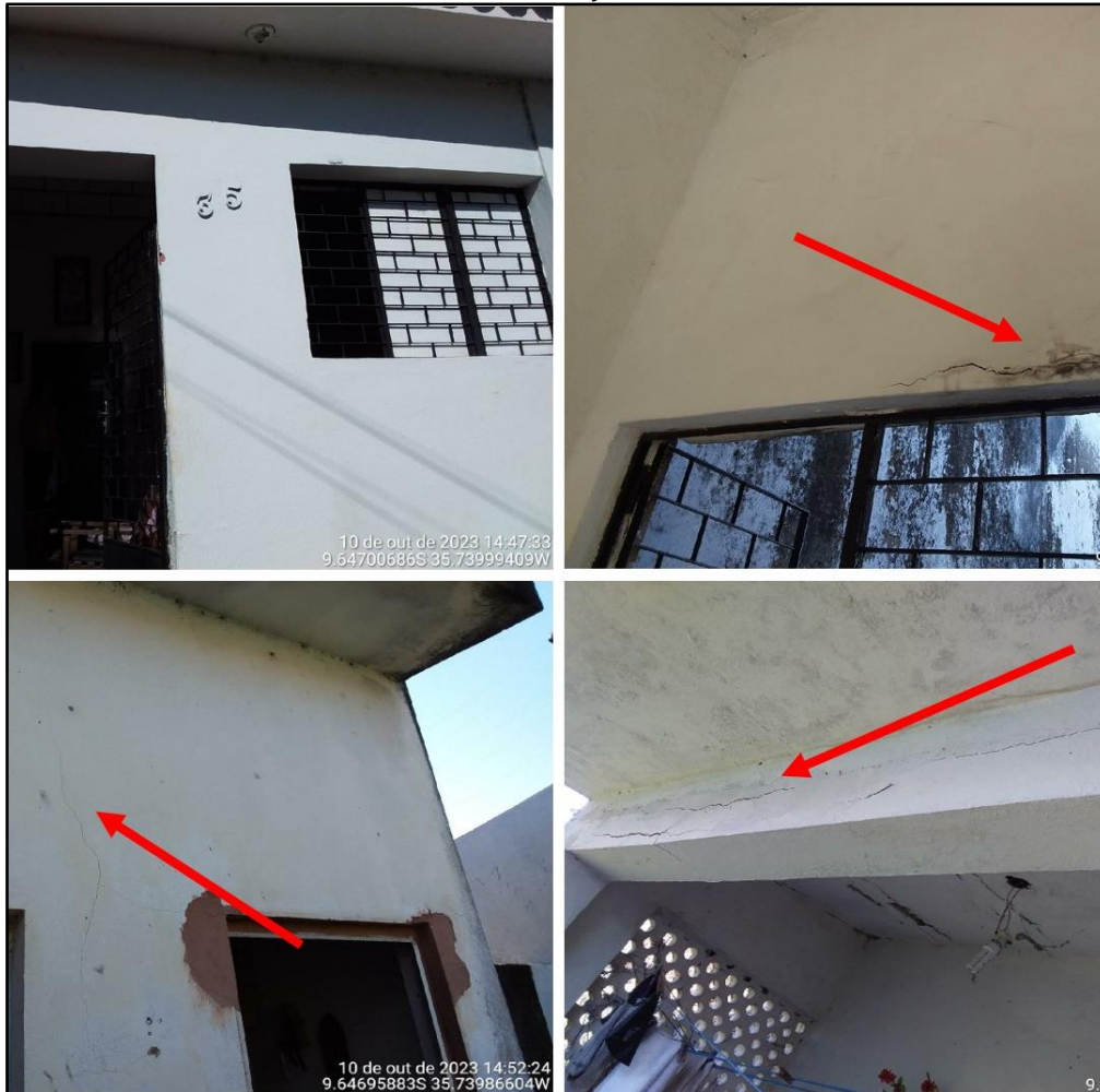
Figura 23 – AT06A_200 – Fissura na horizontal, situada na área interna, com presença de manchas de umidade; Fissura na vertical, situada na fachada da edificação; Fissura na vertical na viga, podendo estar correlacionado a oxidação da armadura.
