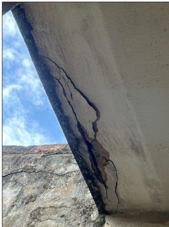
Foto 39: Oxidação da armadura responsável pelo estufamento e consequentes danos na estrutura.
