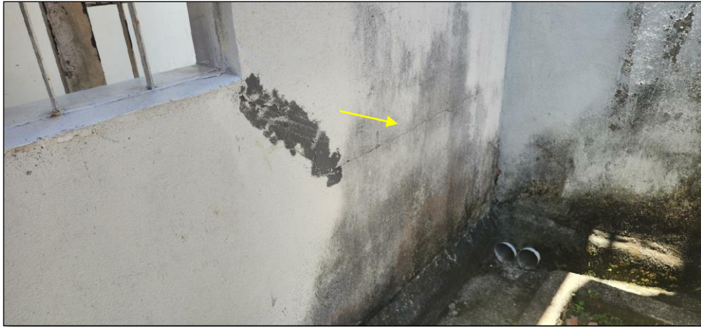
Foto 31: Fissura (seta amarela) se propagando da janela pela parede externa com tipologia inicialmente inclinada e se tornando horizontal. Nota-se a ausência de elementos estruturais essenciais na janela.
