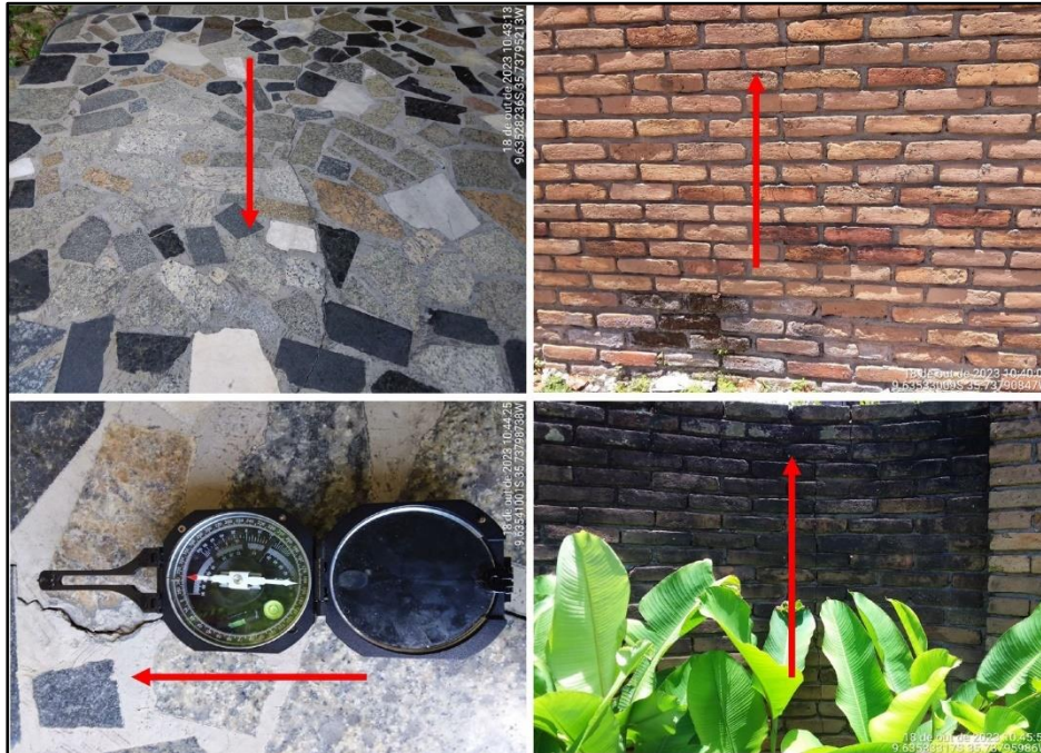
Figura 18 - AT04_34 Fissuras transpassante na vertical; Fissuras no piso com uma certa persistência para outros cômodos. Necesita-se de revisita na edificação nos próximos campo para verificar se houve evolução.
