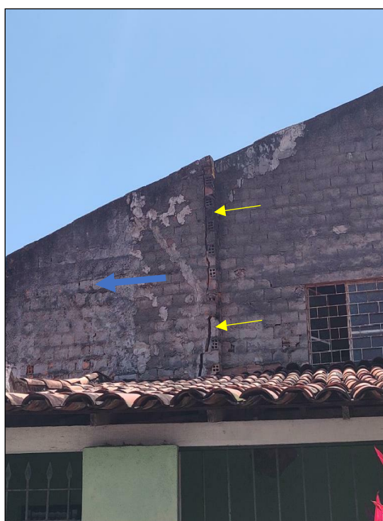
Foto 77: Rachadura transpassante (indicado pelas setas amarelas) na fachada externa de uma construção, indicando recalque para o sentido do caimento da encosta (indicado pela seta azul).
