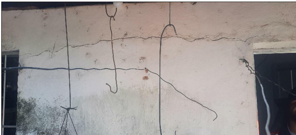
Foto 9: Rachadura horizontal em parede externa onde foi identificado recalque possivelmente relacionado ao sumidouro escavado imediatamente ao lado.
