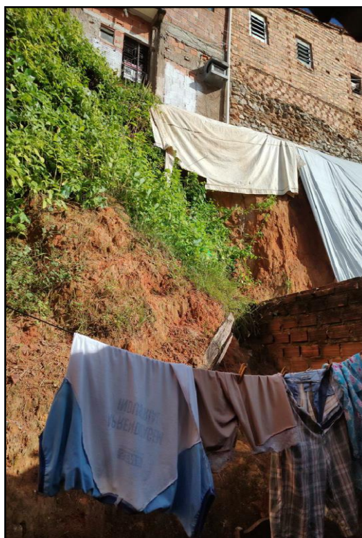
Foto 71: Vista de imóveis construídos em área de risco de deslizamento de encostas, com instabilidades rasas na AT-06A. Observa-se lona plástica no topo da encosta para proteção improvisada contra erosão e deslizamentos.
