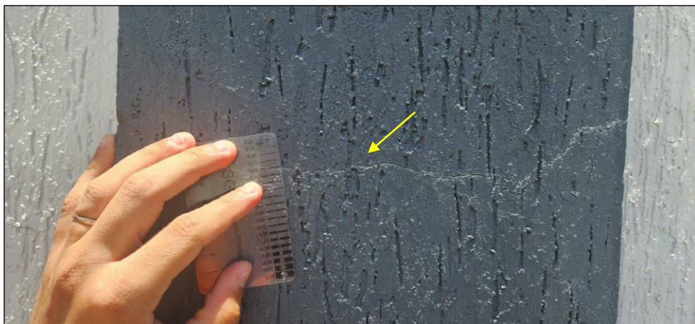
Foto 33: Fissura (seta amarela) incipiente da Foto 32 no detalhe. Abertura máxima de 0,3 mm.
