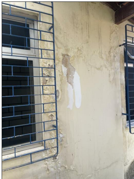
Foto 58: Infiltração severa gerando danos em parede sem a devida manutenção.
