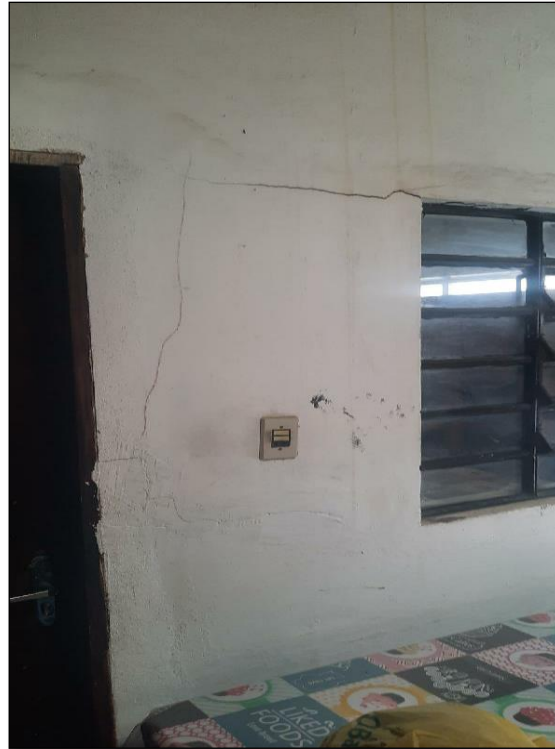
Foto 6: Trinca horizontal que passa a vertical e propaga-se da janela para a porta relacionada à ausência de vergas e contravergas para devida distribuição de tensões.
