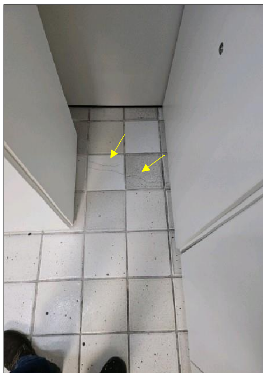
Foto 65: Fissura se propagando pelo piso da sala 03. Direção 65° Az.
