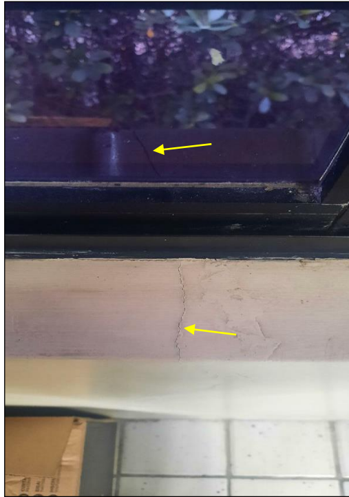
Foto 68: Fissura (indicada pelas setas amarelas) transpassante se propagando pela parede até a janela localizada na sala 02.
