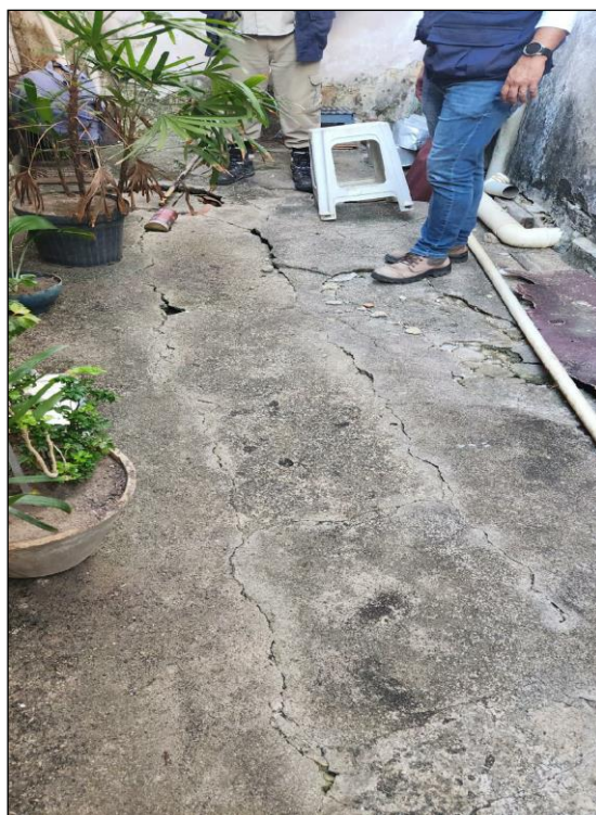
Foto 8: Continuação da depressão da Foto 7 .
