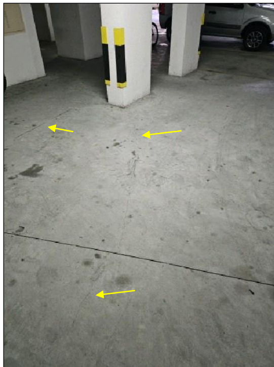
Foto 53: Fissuras (setas amarelas) com diferentes direções se propagando pelo pavimento a partir da coluna. Essas fissuras e coluna não são as mesmas da Foto 52 . Não há padrão direcional nesses danos.
