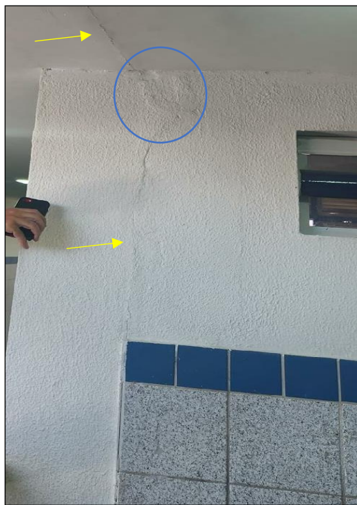
Foto 41: Continuação da fissura (setas amarelas) da Foto 40 , se propagando pela parede. Elipse azul indicando ponto de infiltração.
