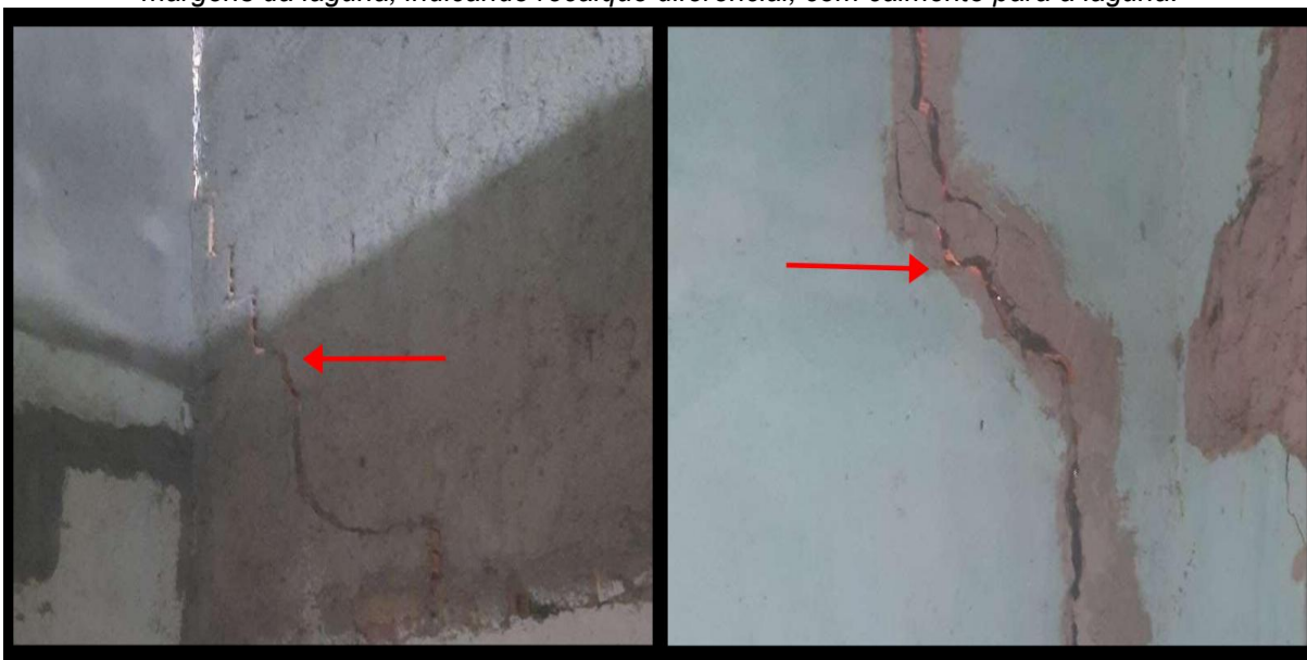
Figura 46 – AT06B_ 838 – Rachadura severa se propagando pelo piso do imóvel construído às margens da laguna, indicando recalque diferencial, com caimento para a laguna.
