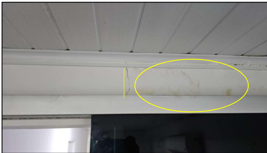
Foto 89: Fissura vertical (linha amarela) no rodapé do teto onde há manchas (elipse amarela) de excesso de umidade. Recepção da diretoria administrativa da ADEFAL.
