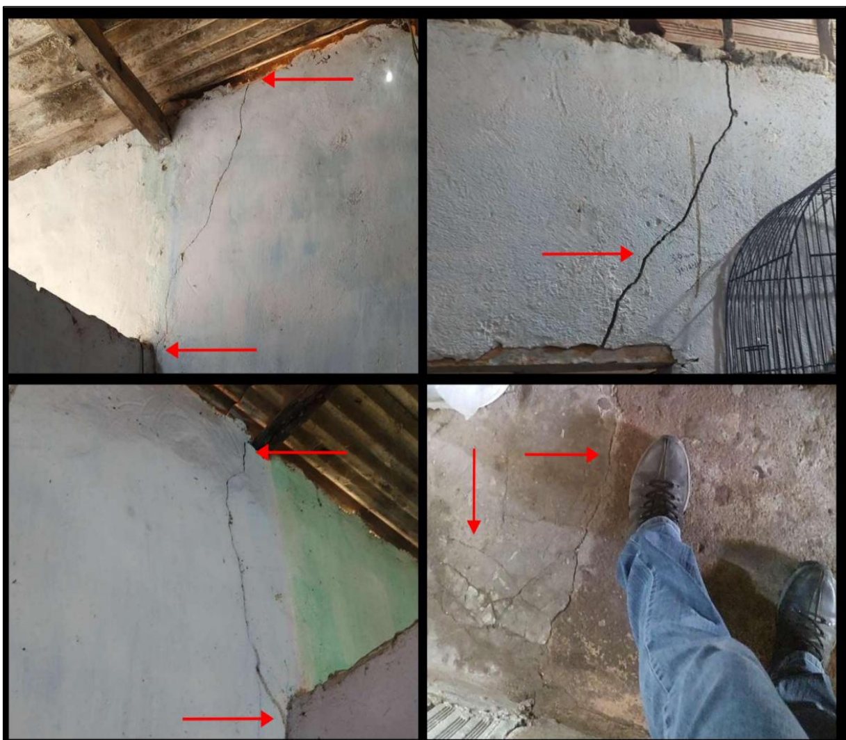
Figura 42 – AT06B_45 – Rachaduras indicando recalques diferenciais com caimento para a laguna e soncavo no piso, em edificação situada próxima à margem da laguna.
