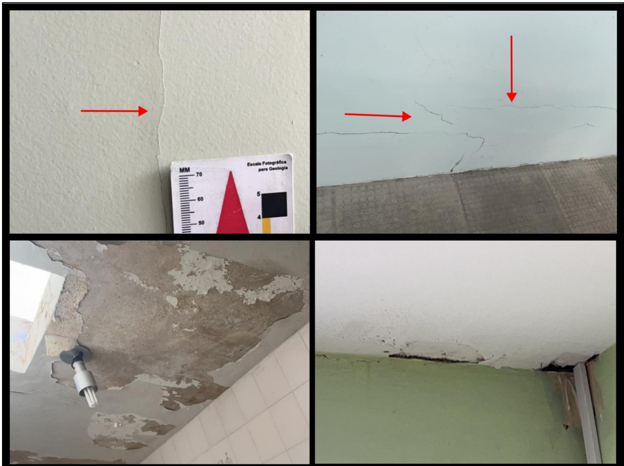
Figura 21 – AT03_81 – Destacamento de reboco e buracos no teto decorrentes de infiltração.
