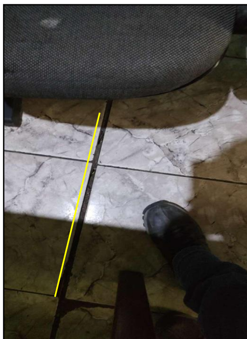
Foto 24: Fissura (linha amarela) se propagando pelo rejunte do piso com direção de propagação paralela a linha da encosta. Mesmo imóvel das Fotos 22 e 23 .
