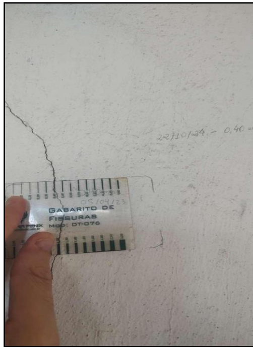
Foto 38: Fissura da Foto 37 , no detalhe. Abertura de 0,40 mm. Sem evolução em relação ao medido no semestre passado.
