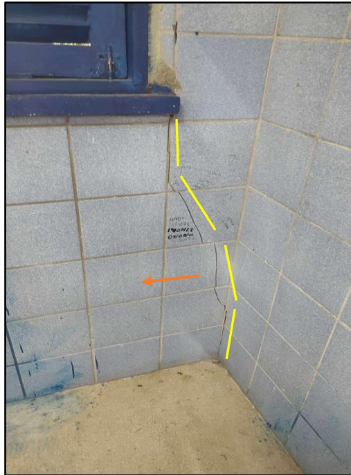
Foto 74: Fissura transpassante (linhas amarelas) em parede oposta do dano conjugado das Fotos 72 e 73 . Sentido do recalque indicado pela seta laranja.
