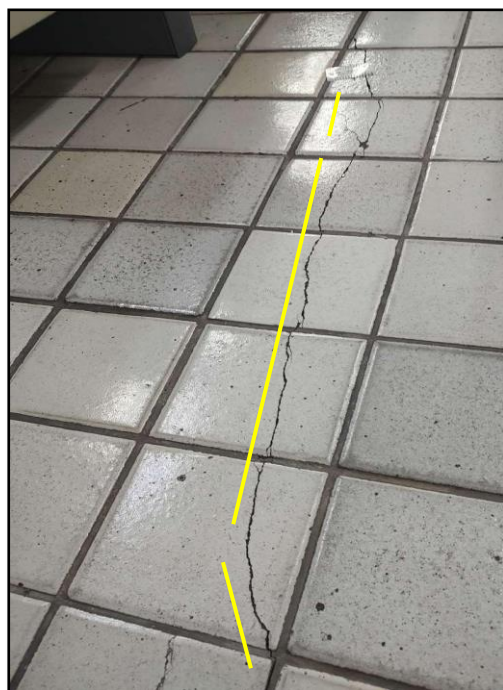
Foto 115: Continuação da trinca (linha amarela) da Foto 114 na Gerência de Pessoas.
