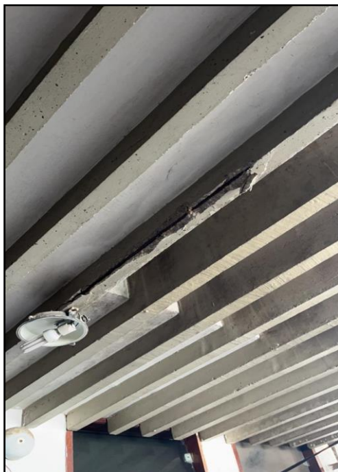
Foto 51: Danos na estrutura (elipse amarela) devido à oxidação da armadura interna.
