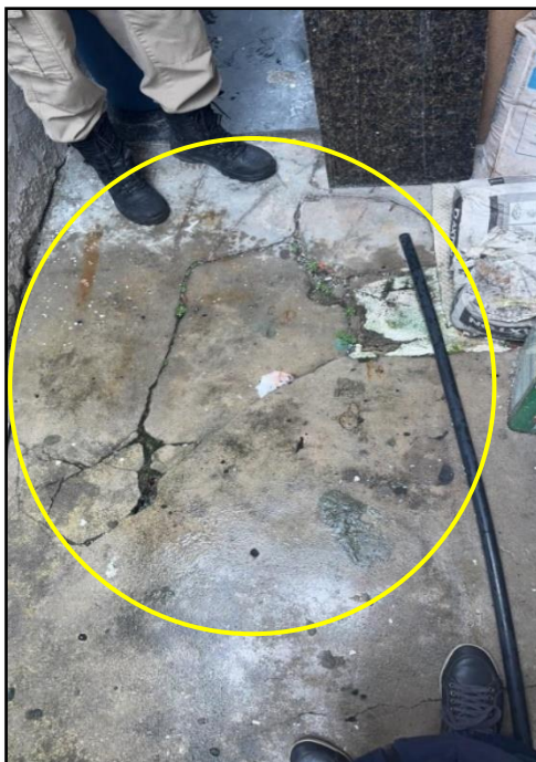
Foto 92: Pavimento afundado e danificado (elipse amarela) pontualmente na linha de uma caixa de passagem subterrânea.
