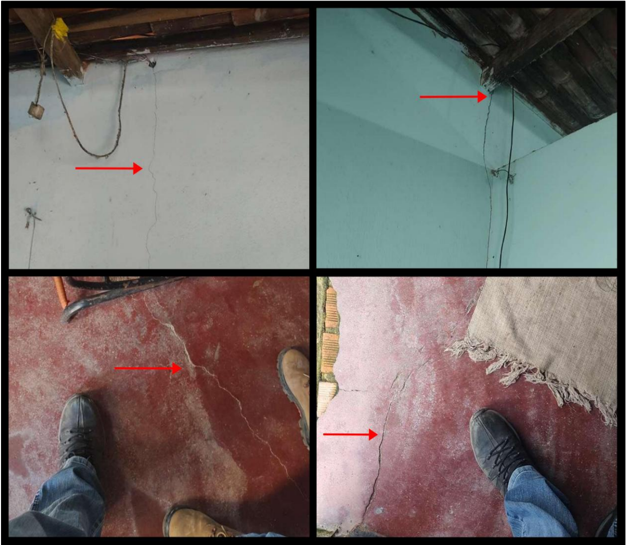
Figura 44 – AT06B_125 – Fissuras na vertical e na base das paredes, com destaque para o pé-direito elevado; Danos com ponto de início na cobertura em madeira, no qual aplica carga direta na alvenaria, causando o surgimento das manifestações patológicas; Fissuras no piso, acompanhadas de son cavo. Ressalta-se a proximidade destas edificações com a laguna.
