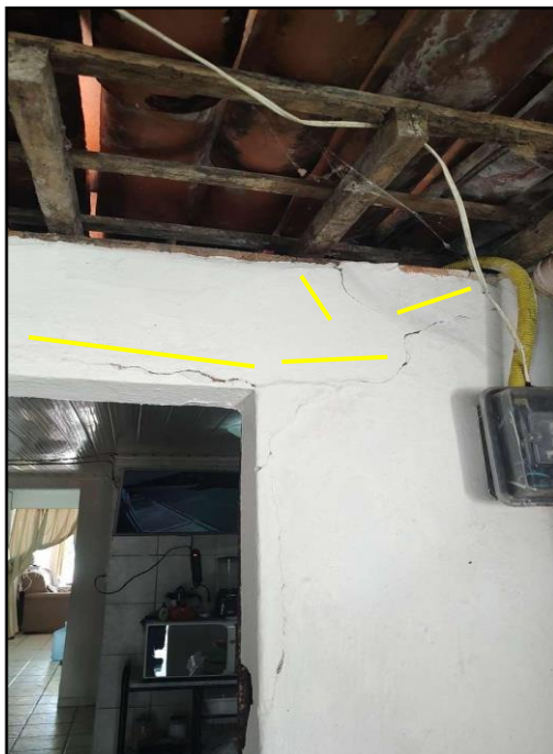
Foto 30: Fissuras (linhas amarelas) se propagando em portal construído em alvenaria autoportante sem elementos de distribuição de tensões.
