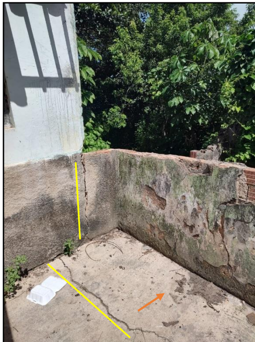
Foto 21: Rachadura se propagando pela laje construída na encosta do tabuleiro. Linhas amarelas indicam direção de propagação paralela a crista da encosta e a seta laranja indica o sentido do recalque coincidente com caimento da encosta.
