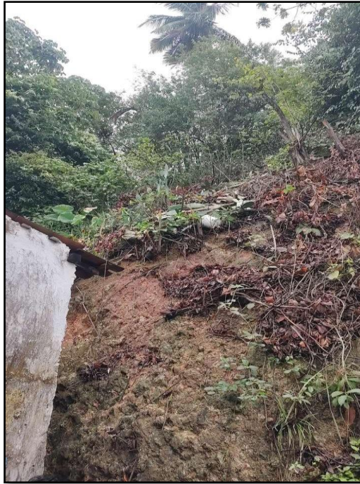
Foto 9: Vista a partir de um patamar mais baixo da encosta localizada nos fundos dos imóveis e evidenciando a situação de vulnerabilidade da barreira com as construções.
