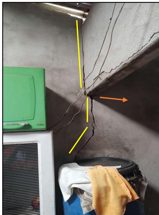
Foto 141: Rachadura se propagando por portal e parede de alvenaria indicando recalque para laguna.
