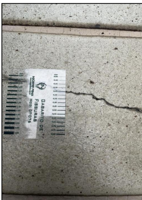
Foto 59: Fissura da Foto 58 , no detalhe. Abertura de 0,25 mm. Não apresentou evolução em relação aos semestres anteriores.
