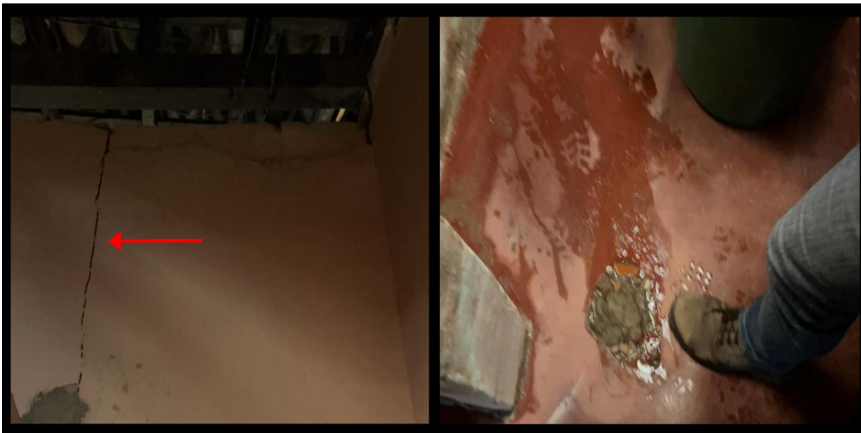
Figura 45 – AT06B_ 460 – Soncavo no piso, umidade excessiva, presença de cupins nas paredes e provavelmente lençol freático raso devido a grande presença de água no piso.
