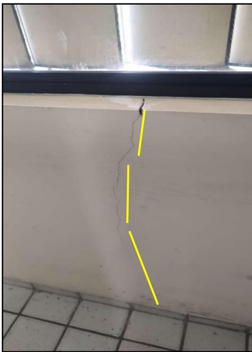
Foto 118: Fissura vertical na base da parede e rodapé da janela na Sala de Arquivos.
