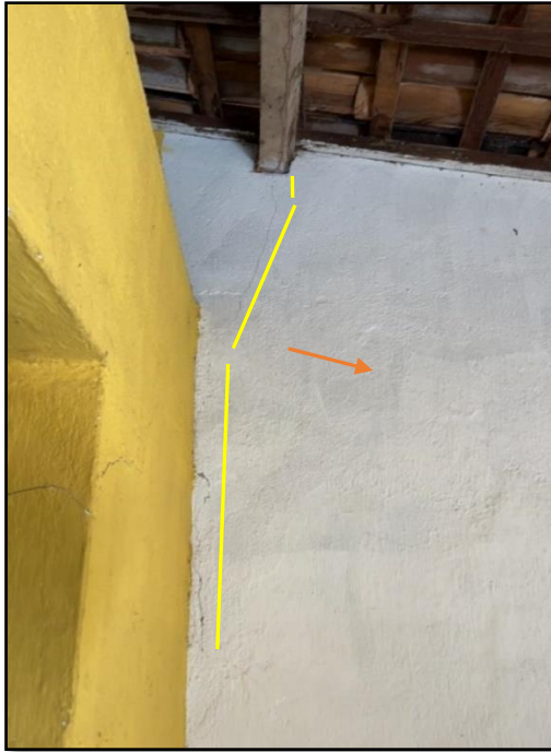
Foto 99: Fissura (linhas amarelas) em parede oposta ao dano da Foto 98 e apresentando direção paralela à linha de crista da barreira. Recalque para o fundo do vale (indicado pela seta laranja).
