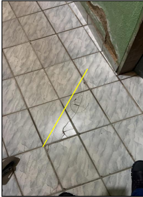
Foto 15: Fissura (linha amarela) no piso onde há um leve afundamento localizado. Mesmo imóvel das Fotos 13 e 14 .
