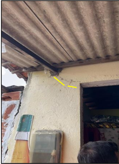
Foto 156: Fissura (linhas amarelas) se propagando a partir de apoio direto do telhado sobre parede de alvenaria até porta sem vergas e contravergas.
