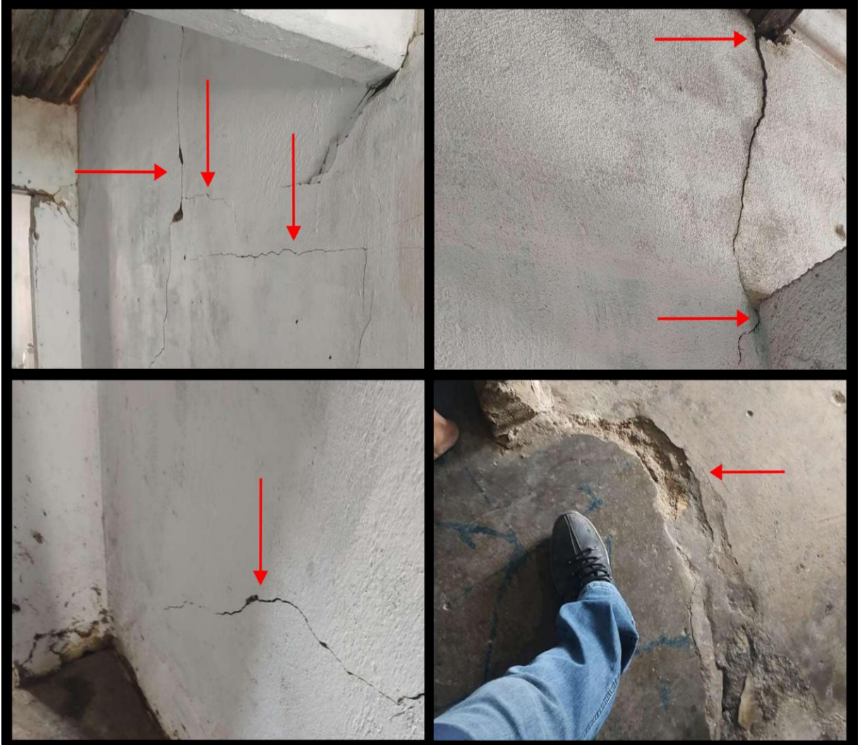
Figura 43 – AT06B_50 – Rachadura iniciada na cobertura em madeira, aplicando carga direta na alvenaria. Dano também identificado no piso, com possível correlação ao tipo construtivo.
