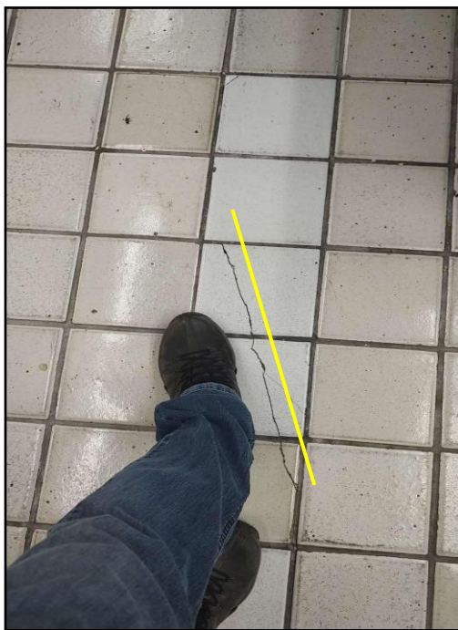
Foto 114: Trinca (linha amarela) se propagando pelo piso da Gerência de Pessoas com direção parcialmente coincidente com o esperado para a borda de subsidência.
