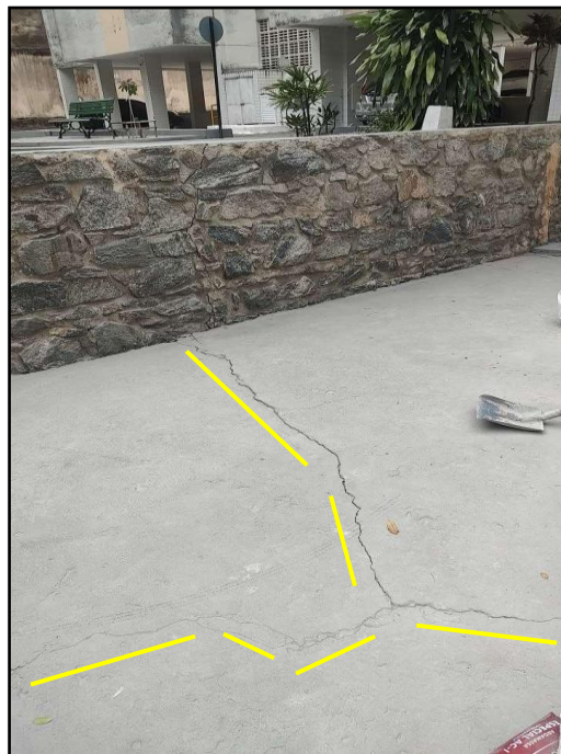
Foto 57: Mesmo pavimento, ao lado da Foto 56 , danificado com trincas e fissuras (linhas amarelas) em diferentes direções. Os danos estão restritos a área em que havia a árvore citada.
