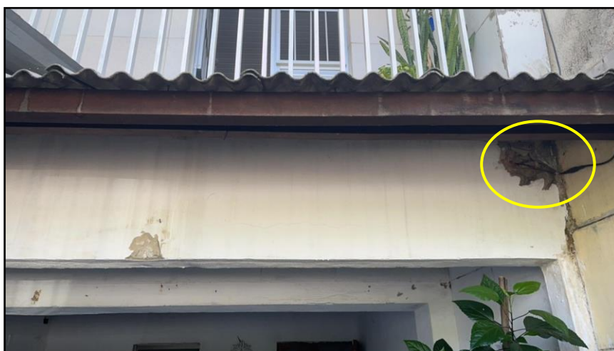
Foto 33: Armadura metálica interna apresentando oxidação (elipse amarela) que ao inflar danificou a estrutura.
