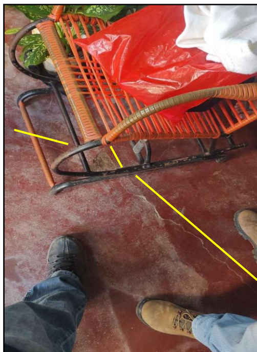
Foto 145: Mesmo piso da Foto 144 com fissuras (linhas amarelas) apresentando locais com afundamento e barulho oco. Diferentes direções de propagação em relação a foto anterior.
