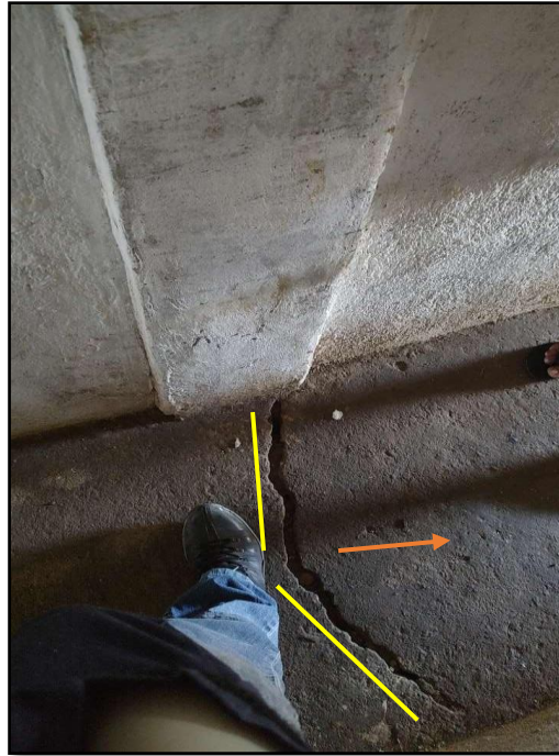
Foto 142: Abatimento do pavimento induzindo rachadura severa (linhas amarelas). Propagação pelo pavimento da mesma rachadura da Foto 141 . Recalque (seta laranja) para o sentido da margem lagunar.
