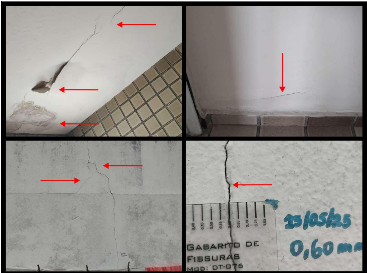
Figura 28 – AT04_10 – Danos relacionados à umidade causando destacamento do reboco, e surgimento de fissura após ampliação do muro situado no fundo do imóvel, com abertura de 0,6mm.
