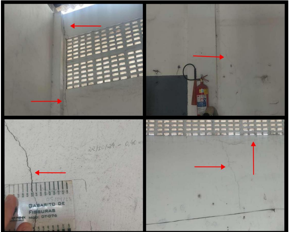
Figura 20 – AT03_18 – Revisita à garagem da SEMINFRA, onde se observaram danos sem evolução em relação aos semestres anteriores.
