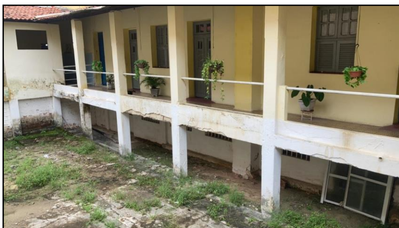
Foto 93: Área externa com reboco e acabamento degradados sem a devida manutenção.
