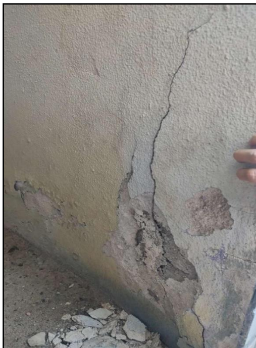
Foto 124: Estrutura metálica interna oxidada gerando fissuramento.
