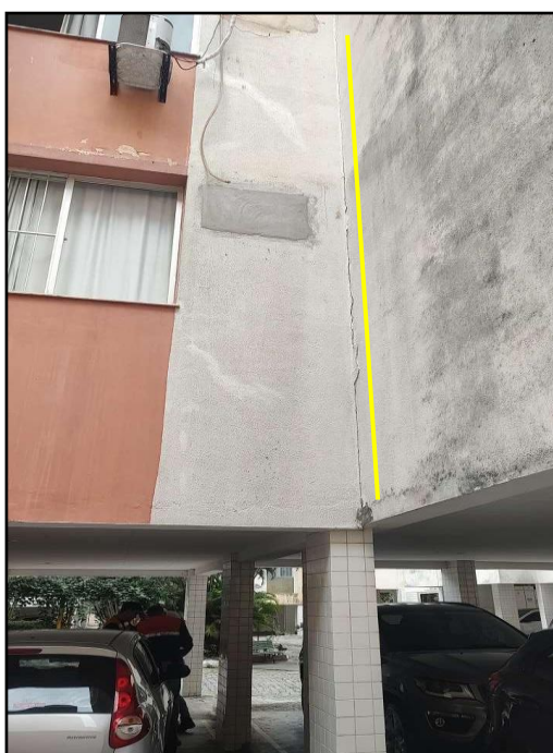
Foto 55: Fissura vertical (linha amarela) se propagando na junção do outro lado dos edifícios.
