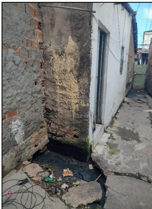
Foto 153: Esgoto a céu aberto percolando ao lado e por baixo de edificações na AT-06B.
