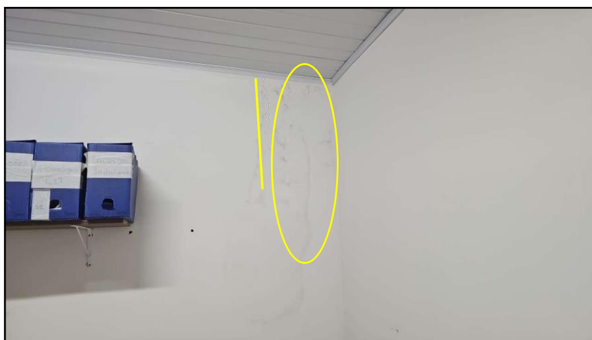
Foto 87: Fissura vertical (linha amarela) em parede com manchas de infiltração (elipse amarela) no departamento de pessoal da ADEFAL.
