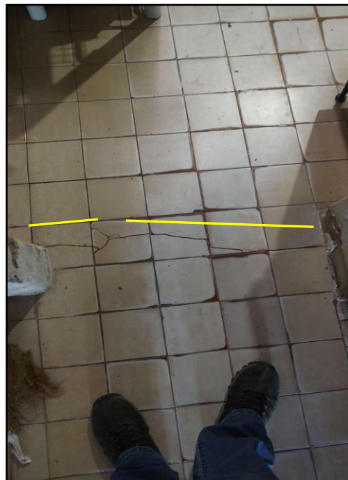
Foto 8: Propagação das trincas (linhas amarelas) das Fotos 6 e 7 pelo piso do imóvel. Direção paralela a linha da encosta.
