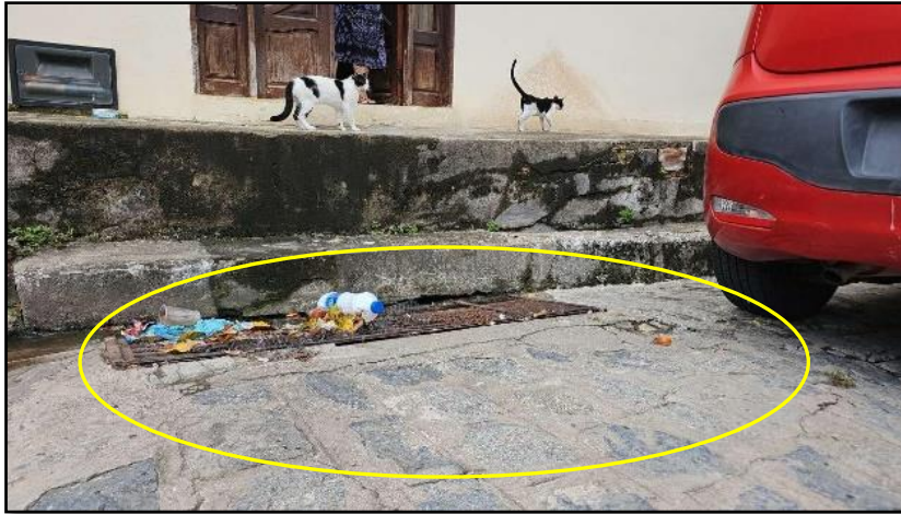
Foto 107: Caixa de passagem apresentando afundamento (elipse amarela) do pavimento ao seu redor em área aterrada entre as encostas do tabuleiro. Moradora relata que foi passada uma tubulação de drenagem por dentro da sua casa, por onde passa a água que vem da rua posterior, mais elevada que o imóvel vistoriado.
