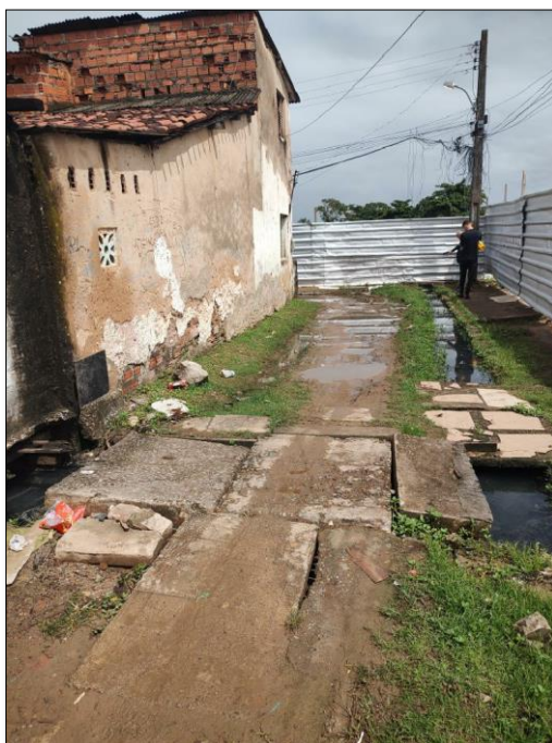
Foto 152: Esgoto a céu aberto percolando ao lado e por baixo de edificações na AT-06B. Apesar de alguns imóveis na AT-06B terem fossas como sistema sanitário, o predomínio é de situações como observa-se na foto (NT.GEO-002.24 (RJQDOSSANTOS)).
