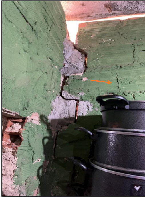
Foto 148: Descolamento de paredes gerando rachadura severa e transpassante. Recalque para leste (seta laranja), ortogonal ao esperado para danos na borda da bacia de subsidência.
