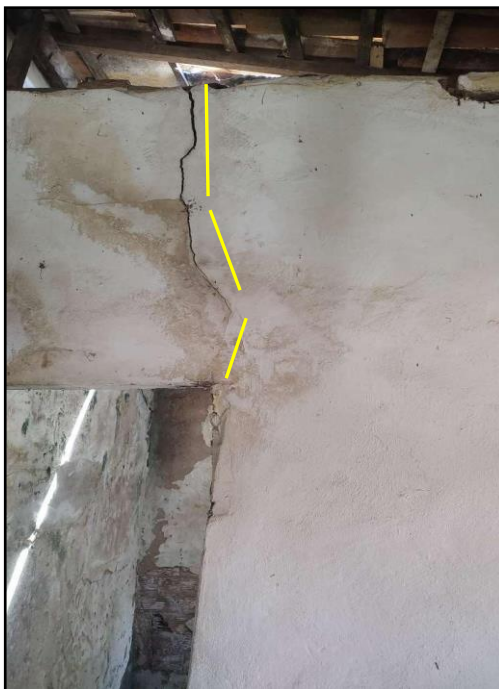
Foto 18: Trinca (linhas amarelas) se propagando em portal de alvenaria sem vergas/contravergas.
