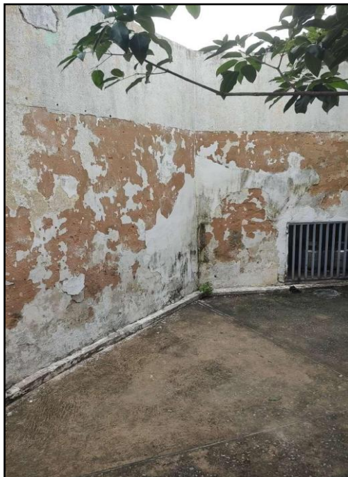
Foto 77: Muro externo do pátio exposto à chuva sem a devida manutenção para preservar o reboco.
