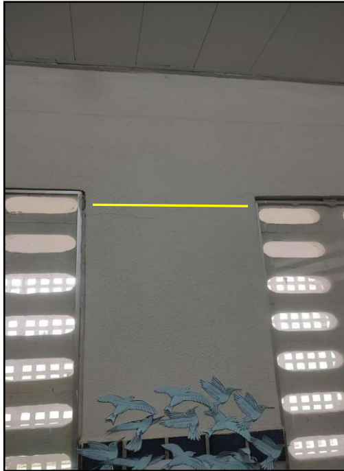
Foto 76: Fissura se propagando entre janelas em cobogó sem vergas e contravergas para distribuição de tensões.
