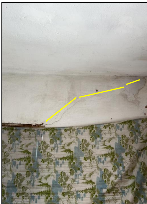
Foto 128: Fissura (linhas amarelas) se propagando em parede de alvenaria a partir de janela sem vergas e contravergas para distribuição de tensões.
