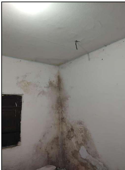
Foto 32: Infiltração severa sem o devido tratamento danificando o reboco da parede.
