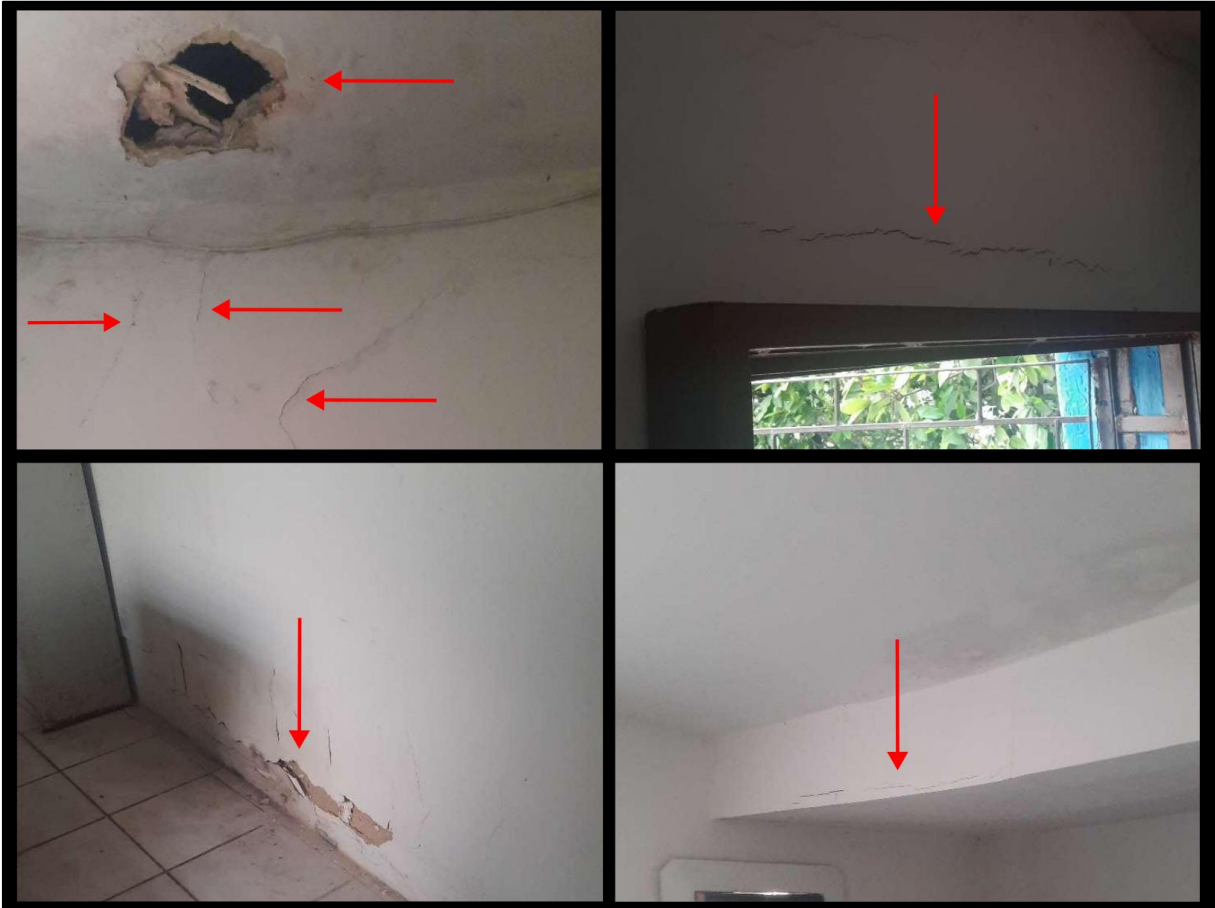
Figura 27 – AT04_59 – Fissuras verticais sem propagação no piso, destacamento de reboco por umidade.
