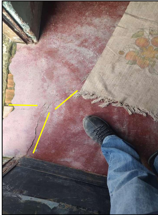
Foto 144: Pavimento fissurado (linhas amarelas) apresentando locais com afundamento e barulho oco.
