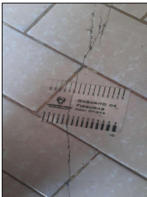
Foto 42: Fissura das Fotos 40 e 41 , no detalhe. Abertura de 0,30 mm. Sem evolução em relação ao semestre anterior.
