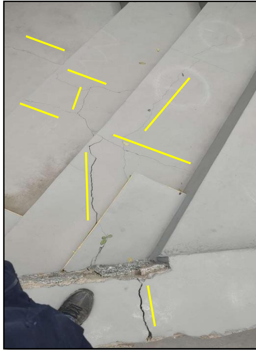
Foto 56: Pavimento danificado com trincas e fissuras (linhas amarelas) em diferentes direções. Os danos estão restritos a área em que havia a árvore citada.
