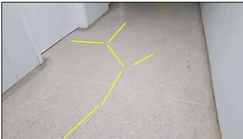
Foto 81: Fissuras incipientes se propagando por piso de granilite em diferentes direções no setor infantil.
