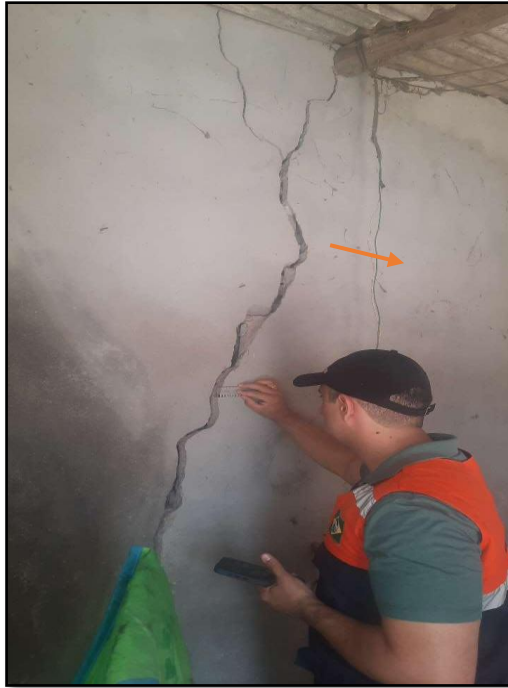
Foto 136: Rachadura severa, transpassante e inclinada/escalonada indicando recalque (seta laranja) para o sentido da margem lagunar.
