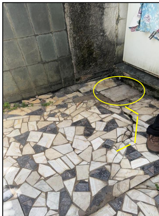
Foto 46: Afundamento de pavimento ao redor de fossa séptica (elipse amarela). O afundamento gerou rachaduras (linhas amarelas) e recalque pontual.
