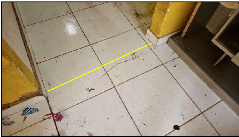
Foto 100: Fissura (linha amarela) se propagando pelo piso do mesmo imóvel das Fotos 98 e 99 apresentando direção paralela à crista da encosta.
