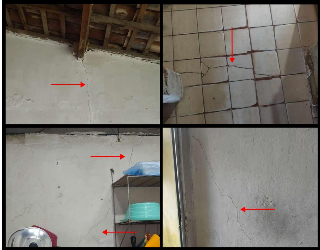
Figura 9 – Ponto AT01_190 – Fissura no piso cerâmico e danos em paredes associados à sobrecarga direta sobre a alvenaria, com inclinação para a encosta, indicando possível recalque diferencial.
