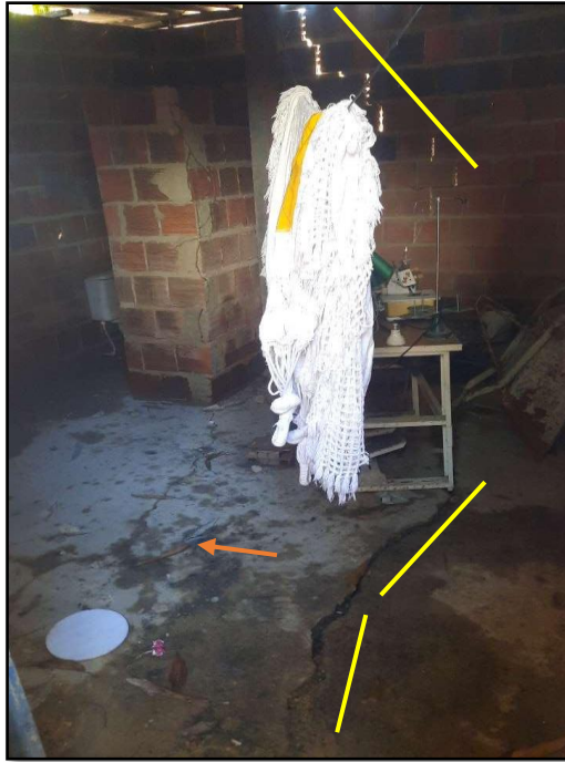
Foto 140: Rachadura severa (linhas amarelas), transpassante e inclinada/escalonada se propagando pela parede e pavimento com indicativo de recalque (seta laranja) para o sentido da laguna.
