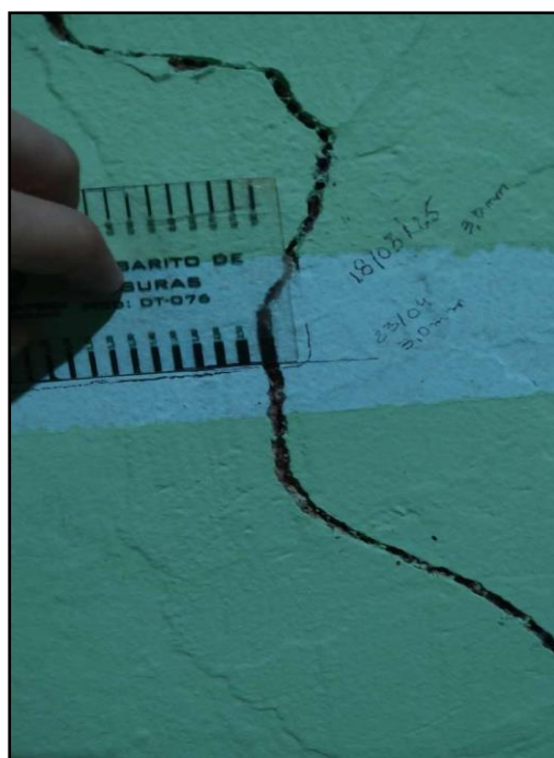
Foto 23: Rachadura da Foto 22, no detalhe. Abertura de 3,0 mm.
