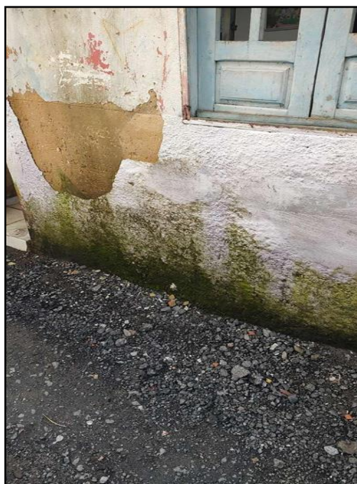
Foto 159: Base da parede com reboco danificado devido ao excesso de umidade. Imóvel localizado em área de inundação.
