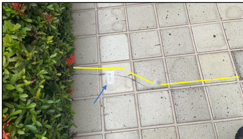
Foto 58: Fissura (linhas amarelas) se propagando pelo pavimento da garagem. Seta azul indicando local de medição da Foto 59 .
