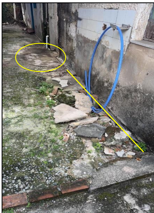
Foto 48: Afundamento de pavimento induzindo descolamento da parede (linha amarela) no local onde há uma fossa (elipse amarela) e uma passagem de água aparentemente danificada.
