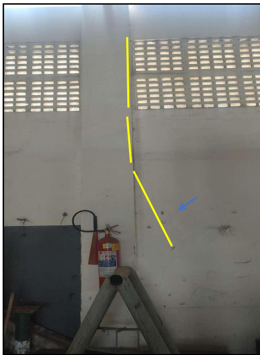
Foto 36: Fissura vertical passando para inclinada (linhas amarelas) se propagando pelo cobogó e parede da garagem da Seminfra. Mesma parede da Foto 34 , local onde ocorrem as patologias. Seta azul indicando local de medição da Foto 37 .
