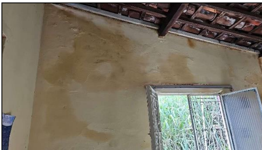
Foto 131: Infiltração severa em parede gerando manchas úmidas no reboco.
