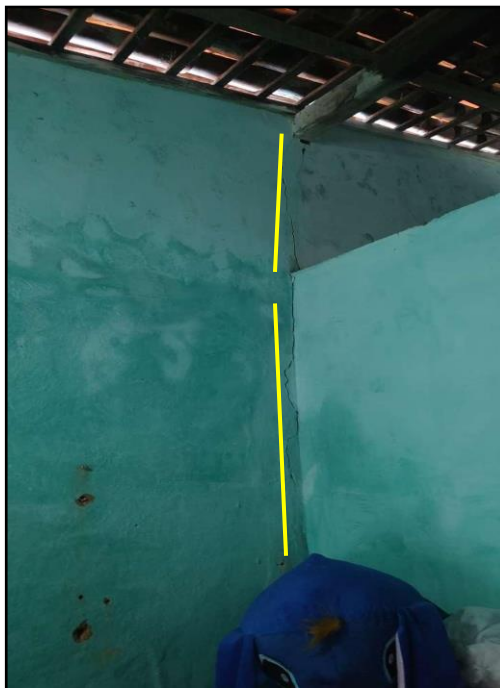
Foto 157: Fissura vertical (linhas amarelas) se propagando do apoio do telhado sobre paredes de alvenaria sem amarração.
