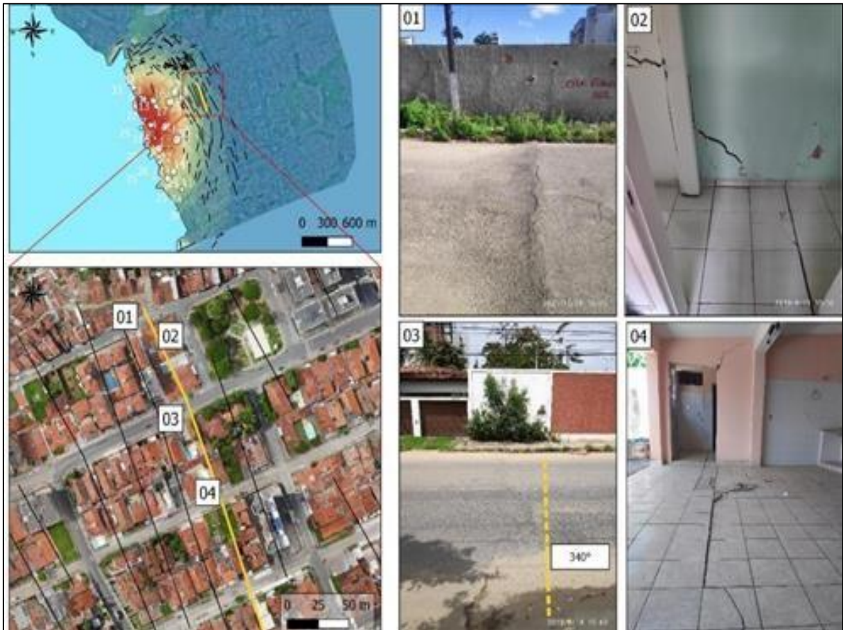
Figura 4 – Feição de fraturamento com direção preferencial de 340°, registradas no piso do imóvel e no pavimento.
