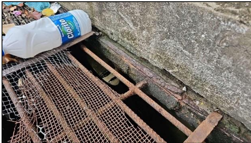
Foto 108: Caixa de passagem da Foto 107 , visto de cima.
