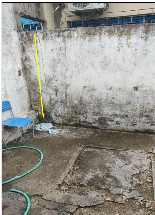
Foto 79: Pavimento danificado com leve afundamento ao redor de caixa de passagem localizada no pátio. O recalque local gerou fissura (linha amarela) no muro ao lado. Observa-se ainda a falta de manutenção da área.
