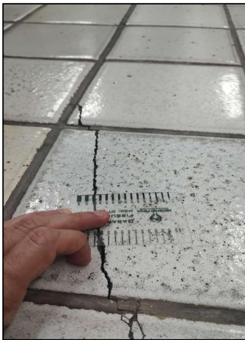
Foto 116: Trinca da Foto 115 , no detalhe. Abertura de 2,0 mm.
