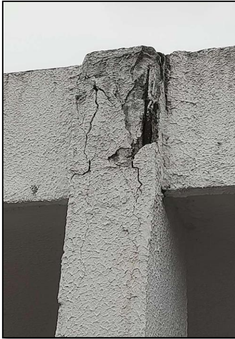
Foto 78: Oxidação da armadura interna gerando estufamento e danos na estrutura exposta à chuva sem a devida manutenção.
