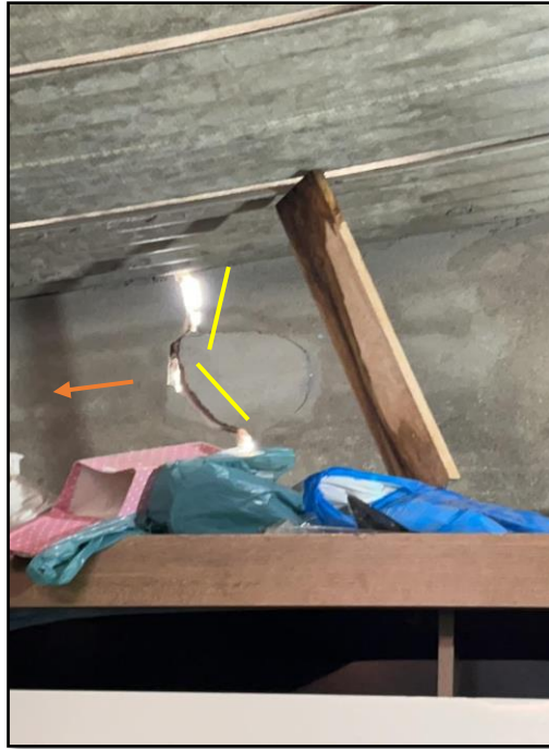
Foto 150: Rachadura severa (linhas amarelas) e transpassante com indicação de recalque para nordeste.
