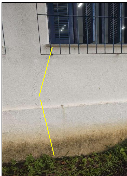
Foto 75: Fissura (linhas amarelas) se propagando pela parede do outro lado de fora sala de aula. Ocorrência próxima do dano da Foto 74 . Nessa imagem é possível observar o desnível entre a sala e a área externa.
