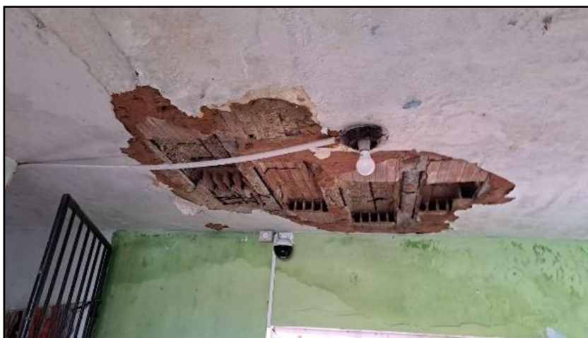
Foto 130: Infiltração sem a devida manutenção oxidando a armadura e danificando o teto.
