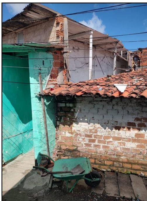
Foto 154: Imóveis com diferença evidente de nivelamento. Enquanto o da direita fez reformas ao longo dos anos para lidar com o histórico rebaixamento, no da esquerda não foram realizadas.
