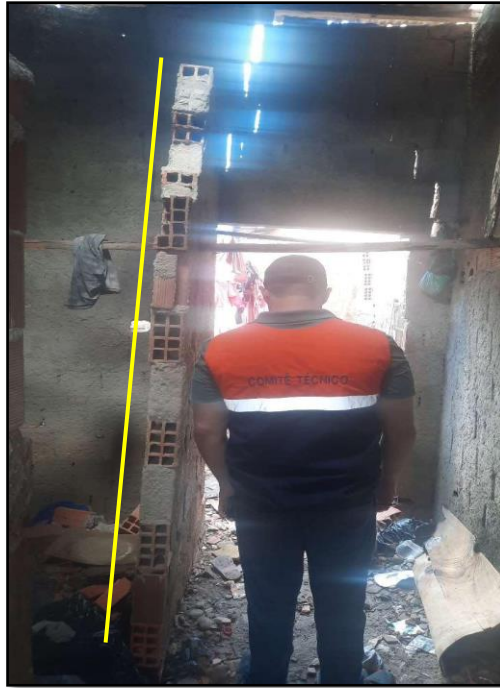
Foto 138: Parede inclinada (linha amarela) devido ao recalque local no mesmo imóvel das Fotos 136 e 137.
