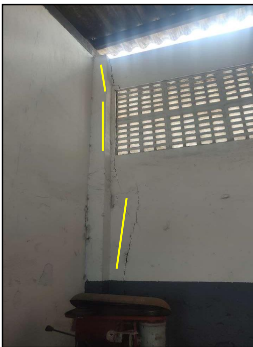
Foto 35: Trincas verticais (linhas amarelas) se propagando pelo cobogó e parede da garagem da Seminfra.
