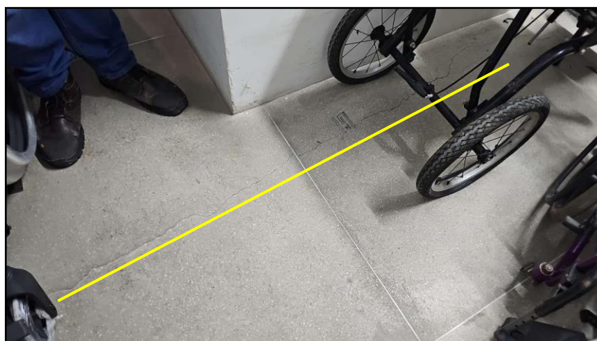
Foto 83: Fissura se propagando pelo piso de granilite do setor de próteses na direção 55°.
