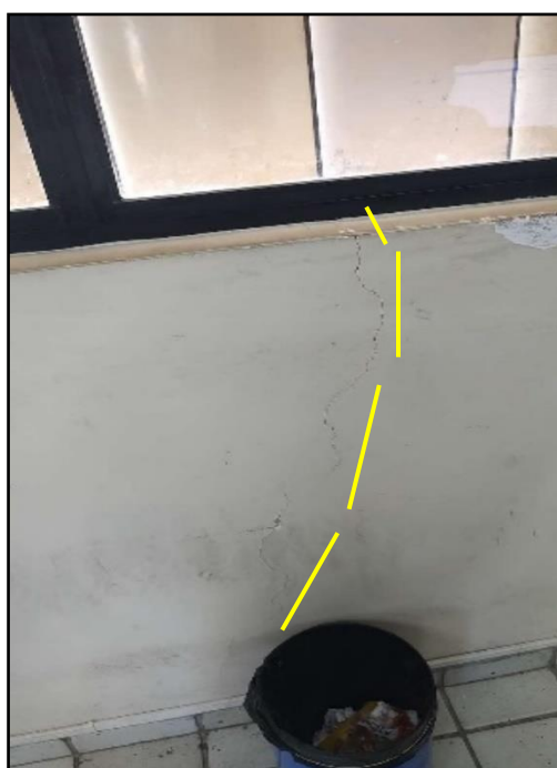
Foto 121: Fissura (linhas amarelas) se propagando pela base da parede e rodapé da janela na Sala de Reprografia.
