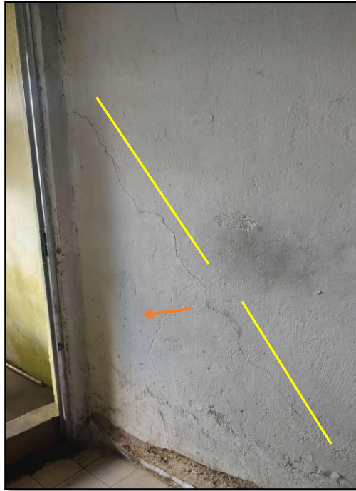
Foto 7: Trinca (linhas amarelas) conjugada com a da Foto 6 , na parede do mesmo cômodo. A trinca indica recalque diferencial no sentido do caimento da encosta (seta laranja).
