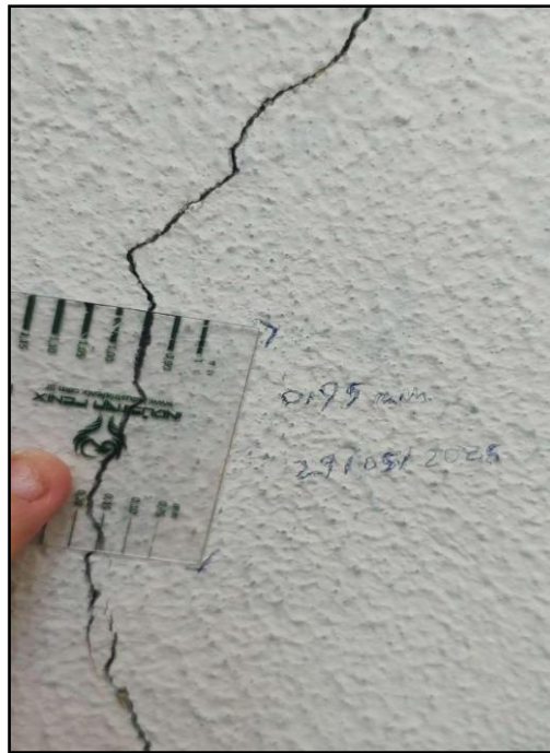
Foto 126: Trinca da Foto 125 , no detalhe. Abertura 0,95 mm.
