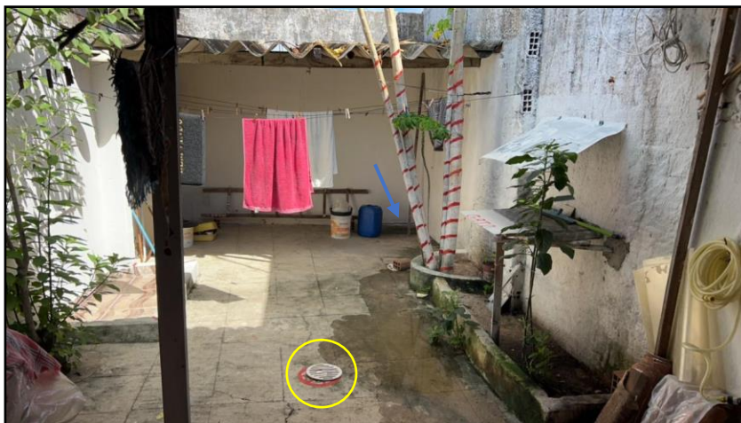
Foto 27: Pavimento do quintal apresentando barulho oco e afundamento (evidenciado pelo acúmulo de água) onde há a presença de uma fossa (elipse amarela). Mesmo imóvel da Foto 28 . Seta azul indicando a presença do dano da Foto 28 .
