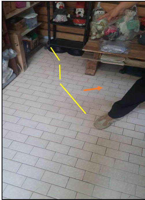
Foto 40: Fissura (linhas amarelas) se propagando pelo piso da garagem de um imóvel revisitado. Não foi identificada propagação para as paredes ou para além do piso da garagem. Seta laranja indicando o sentido do leve recalque.
