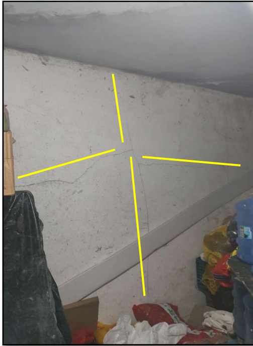
Foto 60: Fissura vertical com ramificações horizontais (linhas amarelas) em parede de depósito do mercado. Não foram identificados outros danos no estabelecimento.
