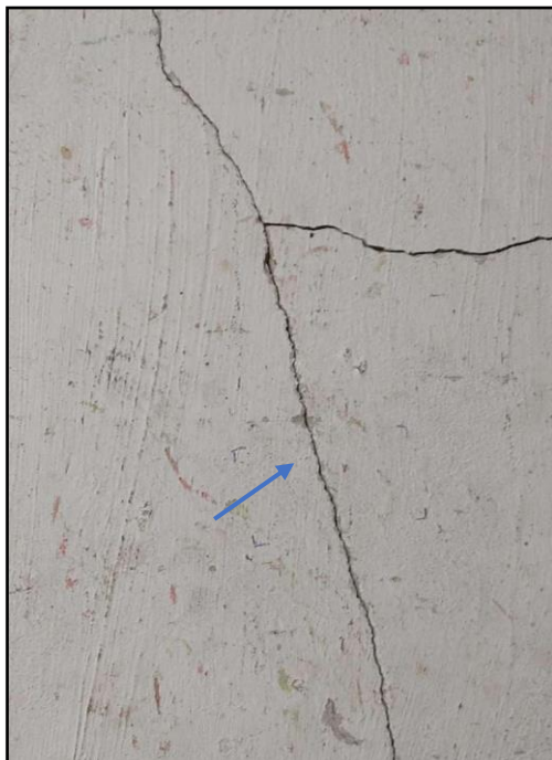
Foto 61: Fissura da Foto 60, no detalhe. Seta azul indicando local de medição da Foto 62.
