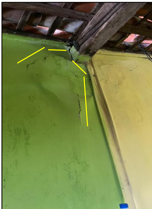
Foto 16: Danos (linhas amarelas) no reboco se propagando a partir do apoio da estrutura do telhado direto na parede de alvenaria
