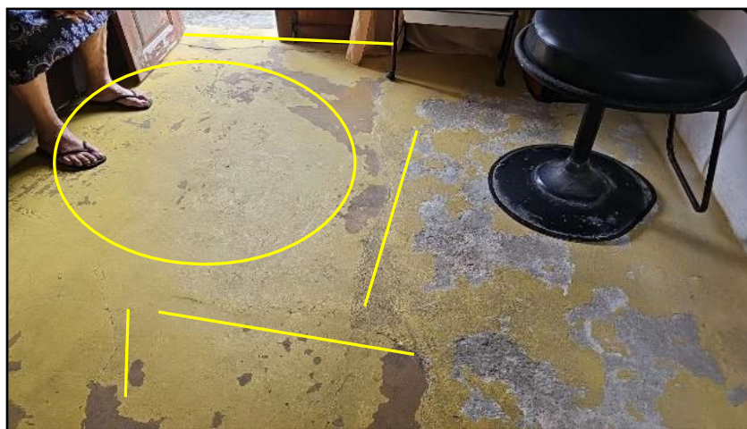
Foto 109: Piso apresentando afundamento (elipse amarela) delimitado por fissuras (linhas amarelas). Imóvel em frente à caixa de passagem das Fotos 107 e 108 .
