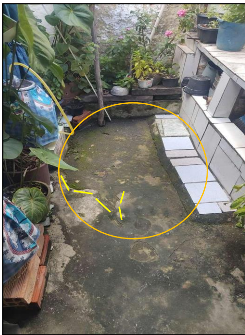
Foto 47: Deformação pontual (elipse laranja) do pavimento de concreto sob uma fossa séptica soterrada no quintal de um imóvel vistoriado. Fissuras indicadas pelas linhas amarelas.
