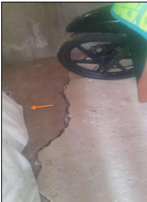
Foto 137: Propagação da rachadura da Foto 136 para o pavimento do mesmo imóvel. É possível observar abatimento do pavimento no sentido da laguna (indicado pela seta laranja).
