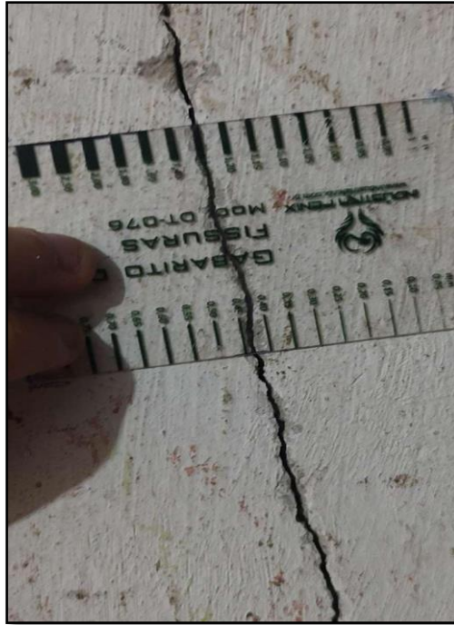
Foto 62: Fissura da Foto 60 e 61 , no detalhe. Abertura de 1,30 mm.
