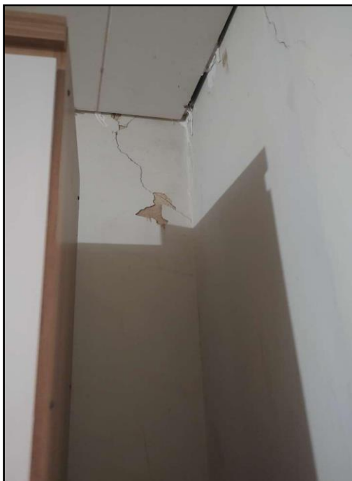
Foto 66: Parede e teto danificados no local onde havia um armário embutido que foi retirado após reforma. Morador relatou que o dano foi em função dessa reforma.
