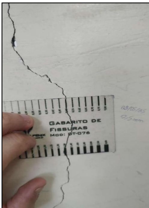
Foto 122: Fissura da Foto 121 , no detalhe. Abertura de 0,50 mm. Sem evolução em relação aos semestres anteriores.
