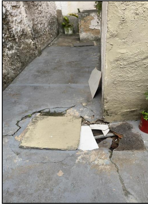
Foto 64: Passagem de esgoto residencial danificada sem a devida manutenção. Pavimento apresenta afundamento e barulho oco no local.
