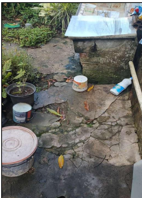
Foto 19: Pavimento danificado e afundado onde há a localização de uma fossa e uma passagem de água utilizada da casa.
