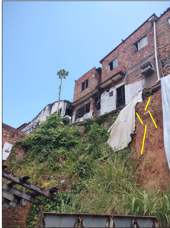
Foto 96: Vista de imóveis construídos em área de risco de deslizamento na AT-06A. Observa-se lona plástica rasgada no topo da encosta para proteção improvisada contra erosão e deslizamentos. Foram observadas fissuras no talude (linhas amarelas).
