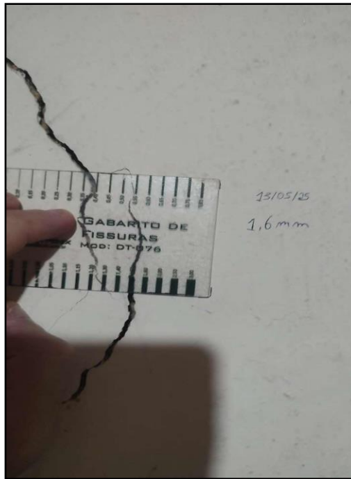
Foto 45: Fissura das Foto 44 , no detalhe. Abertura de 1,6 mm.
