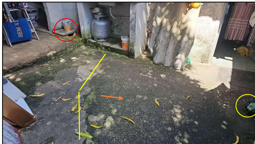
Foto 26: Pavimento apresentando afundamento (delimitado pelas linhas amarelas) com recalque para o sentido (indicado pela seta laranja) de uma fossa séptica. Mesmo imóvel da Foto 29 . Elipse amarela indicando a fossa e elipse vermelha indicando caixa de gordura.
