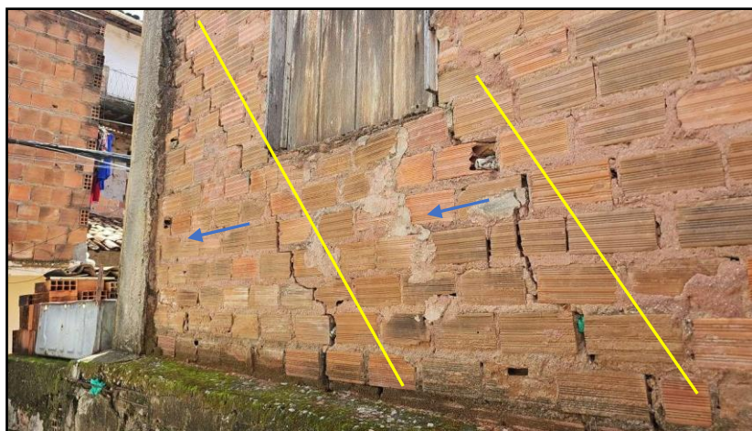
Foto 104: Rachaduras (linhas amarelas) inclinadas/escalonadas e transpassantes em parede de imóvel indicando recalque para o fundo do vale (setas azuis). Mesmo imóvel das Fotos 102 e 103 .
