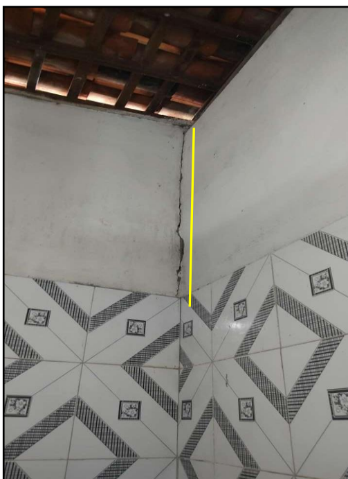
Foto 17: Fissura (linha amarela) relacionada a ausência de amarração entre paredes de alvenaria autoportante.
