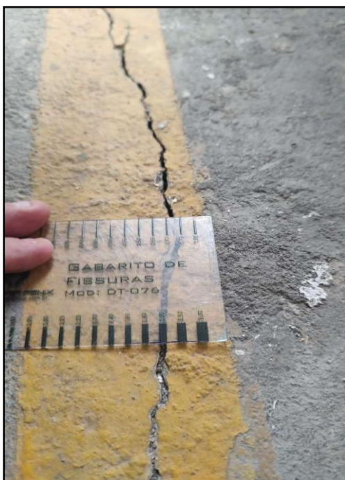
Foto 53: Fissura da Foto 52, no detalhe. Abertura de 2,00 mm.
