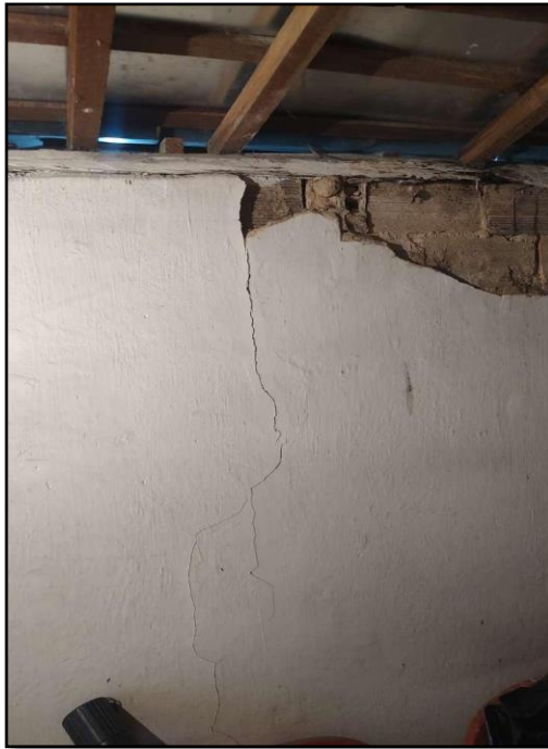
Foto 43: Trinca vertical se propagando pela parede, aparentemente restrita ao reboco.
