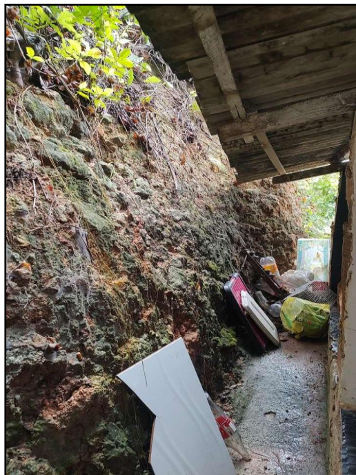
Foto 10: Vista a partir dos fundos do imóvel tipicamente construído em área afetada por deslizamento de encostas na AT-01. Observa-se ausência de obra de contenção para evitar esse tipo de situação.
