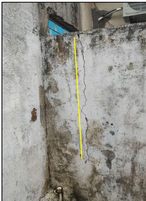
Foto 80: Fissura vertical (linha amarela) no muro da Foto 79 , no detalhe.
