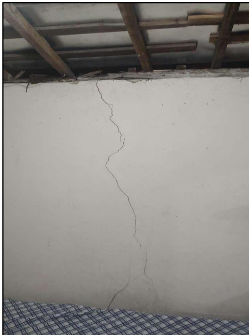
Foto 44: Trinca levemente inclinada se propagando pela mesma parede da Foto 43 , porém do outro lado, em outro cômodo.
