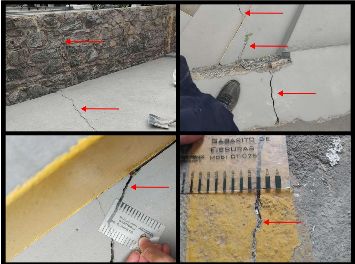
Figura 26 – AT04_21 – Danos no piso possivelmente associados às raízes de uma antiga árvore de grande porte extraída do local.
