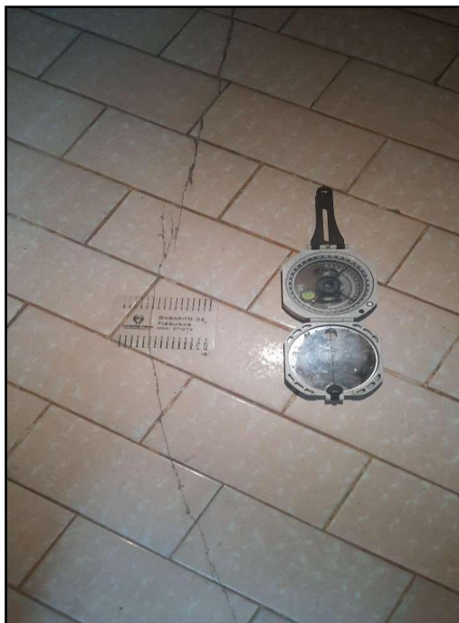
Foto 41: Indicativo do local de medição e direção do fissuramento 305az da Foto 40 . Essa direção não é compatível com o esperado para danos relacionados a bacia de subsidência nessa região.
