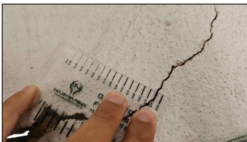
Foto 103: Trinca da Foto 102 , no detalhe. Abertura de 0,75 mm.
