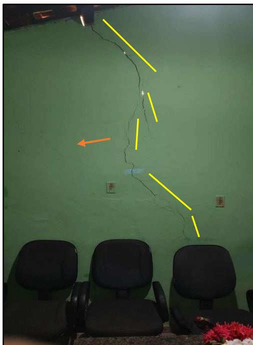
Foto 22: Rachadura transpassante (linhas amarelas) em parede de imóvel construído imediatamente na encosta do tabuleiro. Seta laranja indica o sentido do recalque para o caimento da encosta.
