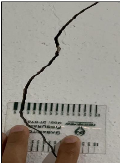
Foto 112: Trinca da Foto 111 , no detalhe. Abertura de 2,50 mm.
