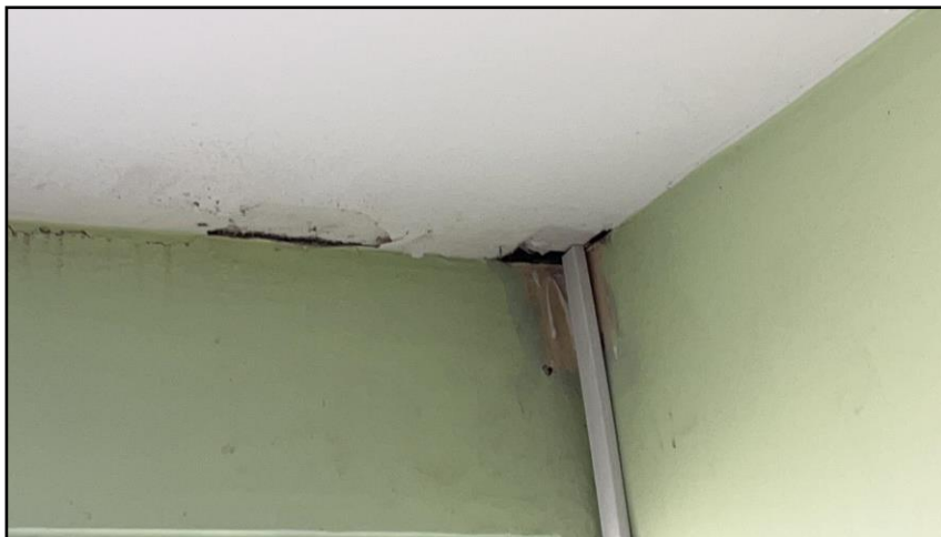
Foto 49: Buracos no teto devido à infiltração de águas pluviais.
