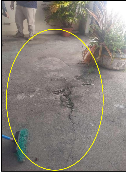
Foto 25: Pavimento de concreto danificado (elipse amarela) no local onde o morador indicou a existência de uma fossa desativada.
