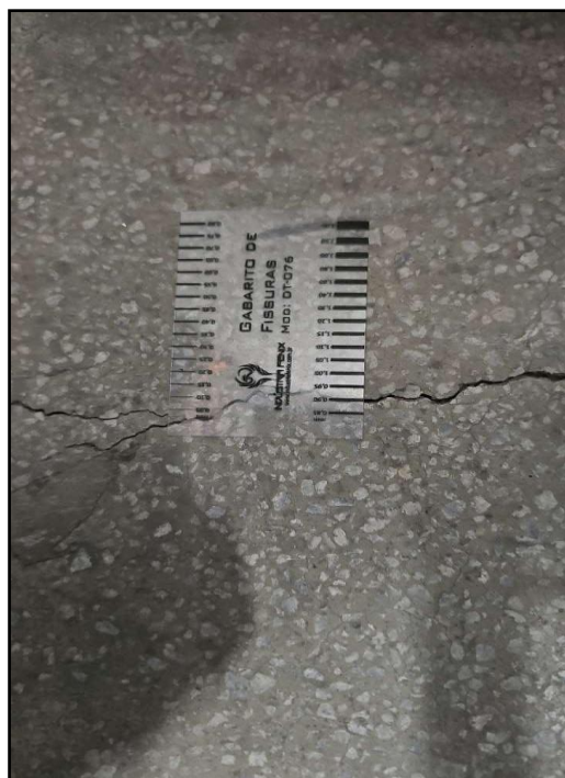
Foto 84: Fissura da Foto 83 , no detalhe. Abertura de 0.90 mm.
