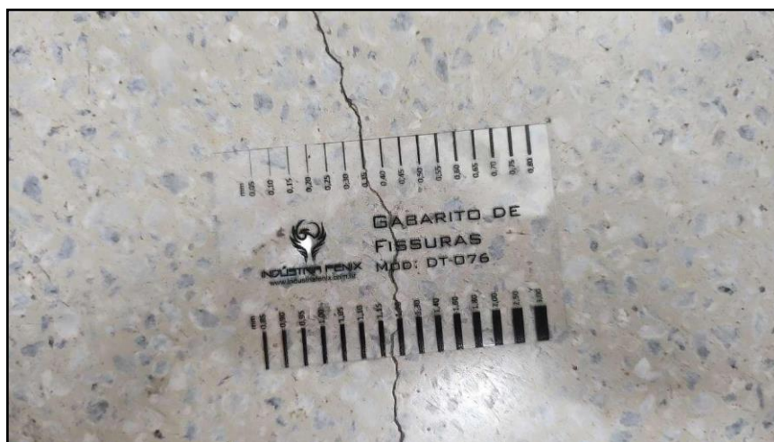
Foto 82: Fissura da Foto 81 , no detalhe. Abertura de 0.35 mm.
