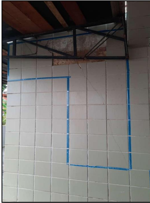
Foto 90: Pastilhas se soltando em parede externa exposta devido a degradação ao longo do tempo.
