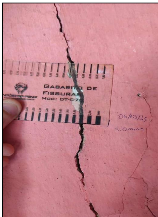
Foto 5: Trinca da Foto 4 , no detalhe. Abertura de 2,0 mm.
