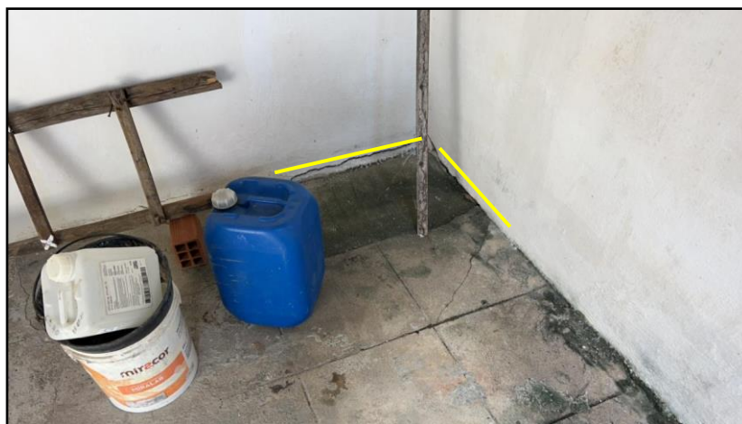
Foto 28: Trinca horizontal na base da parede e descolamento (linhas amarelas) entre paredes e pavimento devido à afundamento induzido por erosão superficial. Mesmo imóvel da Foto 27 . Local do dano indicado na Foto 27 .
