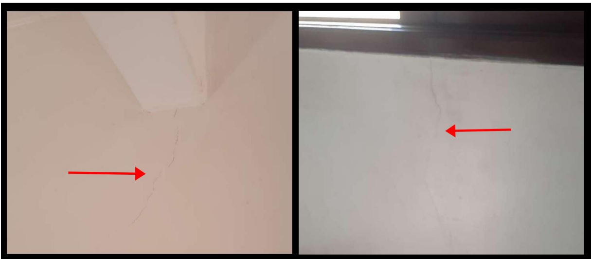
Figura 16 – AT02_465 – Microfissuras concentradas próximas a viga e janela, sem continuidade com o piso.
