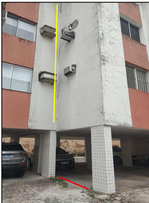
Foto 54: Fissura vertical (linha amarela) se propagando na junção entre os edifícios. Linha vermelha indicando local de ocorrência da fissura da Foto 52 .
