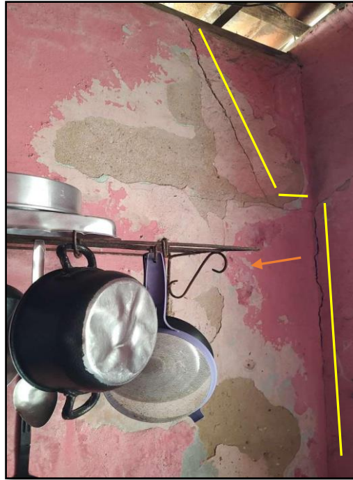
Foto 3: Trincas (linhas amarelas) se propagando pela parede de cômodo nos fundos de imóvel construído no topo da encosta. Indicativo de recalque no sentido do caimento da encosta (seta laranja), em sintonia com movimentações a ela associadas. A direção de propagação da rachadura não é compatível com o que seria esperado em uma região de borda de subsidência como delimitada.
