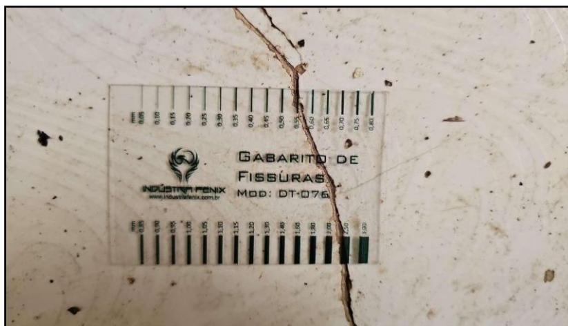
Foto 101: Fissura da Foto 100 , no detalhe. Abertura de 0,55 mm.
