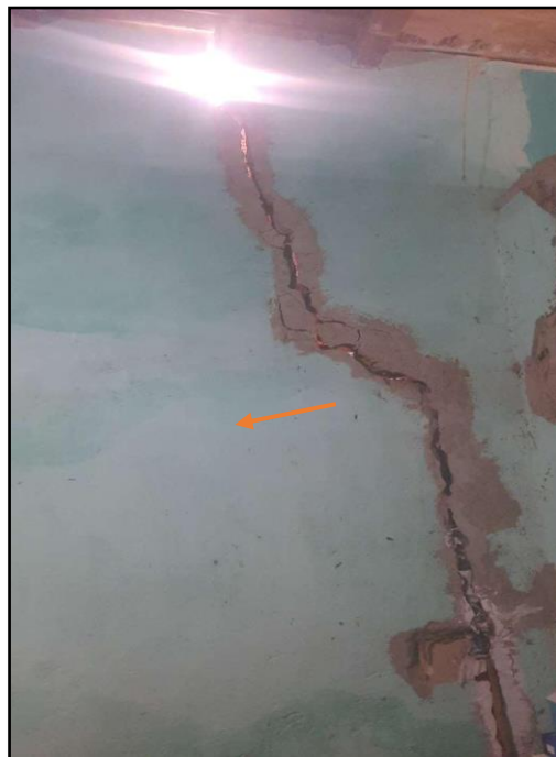
Foto 139: Rachadura severa, transpassante e inclinada/escalonada se propagando por parede de imóvel nas margens da laguna com recalque (indicado pela seta laranja) associado para o seu sentido.
