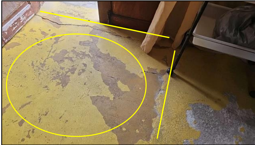
Foto 110: Dano da Foto 109 , no detalhe. Elipse amarela indicando afundamento e linhas amarelas indicando as fissuras.
