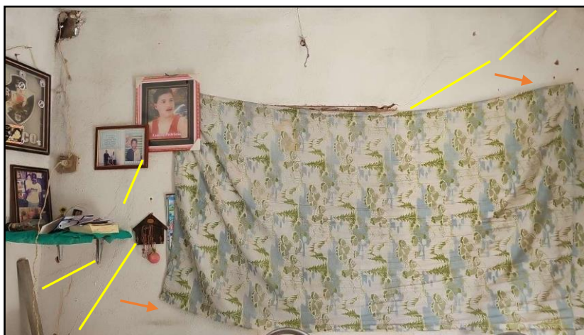
Foto 102: Trinca inclinada (linhas amarelas) se propagando pela parede e indicando recalque (setas laranjas) para o fundo do vale.
