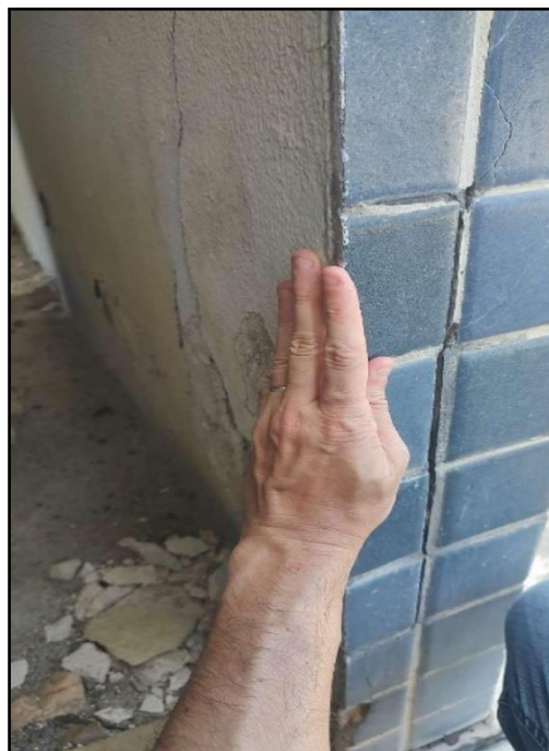
Foto 127: Deslocamento da pastilha e fissuramento da estrutura lateral da Superintendência Estadual dos Correios.
