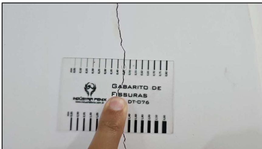
Foto 86: Fissura da Foto 85 , no detalhe. Abertura de 0,45 mm.
