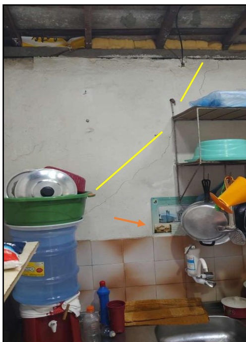
Foto 6: Trinca inclinada (linhas amarelas) se propagando da parede e indicando recalque para o sentido de caimento da encosta (seta laranja). Imóvel diferente das Fotos 3 a 5 .
