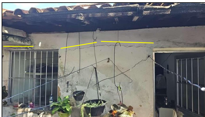
Foto 29: Parede trincada (linhas amarelas) com provável relação com fossa e caixa de gordura bem próximas que causaram os danos no pavimento da Foto 26 . Mesmo imóvel da Foto 26 .
