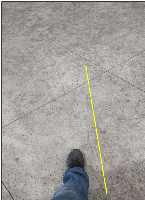
Foto 69: Continuação da fissura (linhas amarelas) da Foto 68 . Sem recalque evidente.
