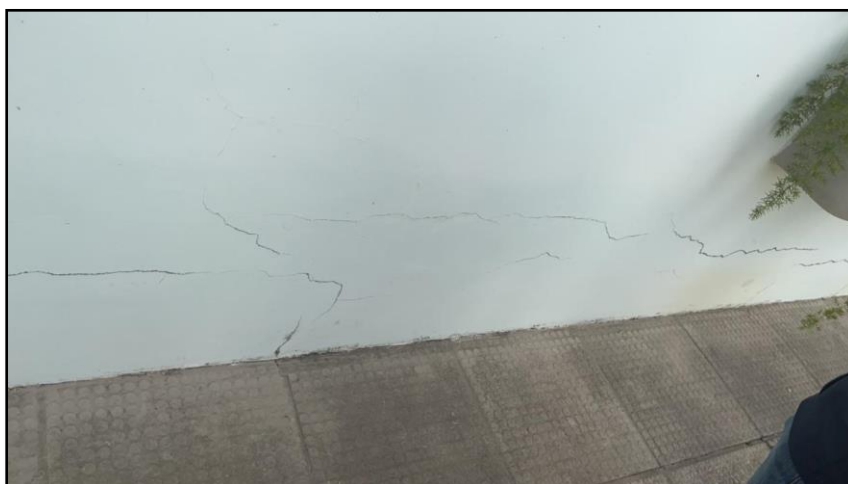
Foto 50: Danos no reboco da base da parede devido à ascensão da umidade por capilaridade da água.
