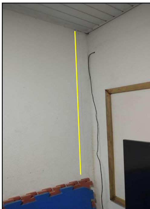
Foto 71: Fissura vertical (linha amarela) em parede oposta da mesma sala de aula do dano da Foto 70 . Não há propagação para o piso. Direção inferida a partir da localização dos danos nas paredes.
