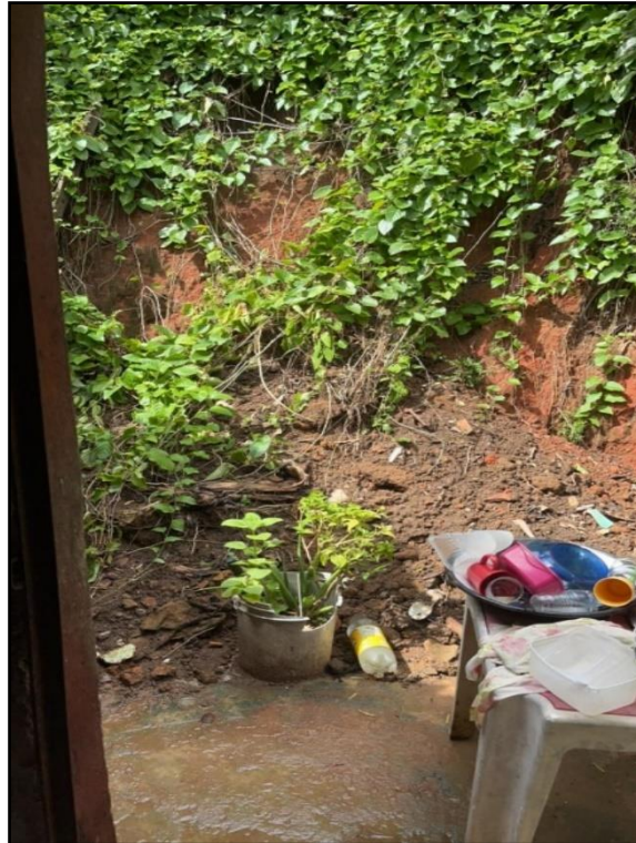
Foto 97: Vista do quintal dos fundos de um imóvel localizado na base da encosta. Essa situação de deslizamentos de barreira é relativamente comum em períodos de fortes chuvas.
