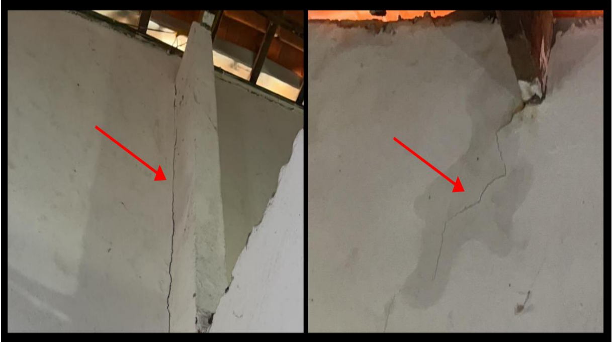
Figura 8 – Ponto AT01_28 – Fissura entre as alvenarias, possivelmente correlacionada à ausência de amarração, e fissura resultante de sobrecarga pela madeira aplicada diretamente sobre a alvenaria.
